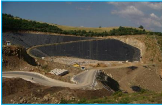
Εικόνα 2-5 Φωτογραφία από ΧΥΤΑ. Φαίνονται μέρος των έργων που γίνονται πριν την απόθεση των απορριμμάτων (πηγή: Νταρακάς, 2014 σελίδα 13)
