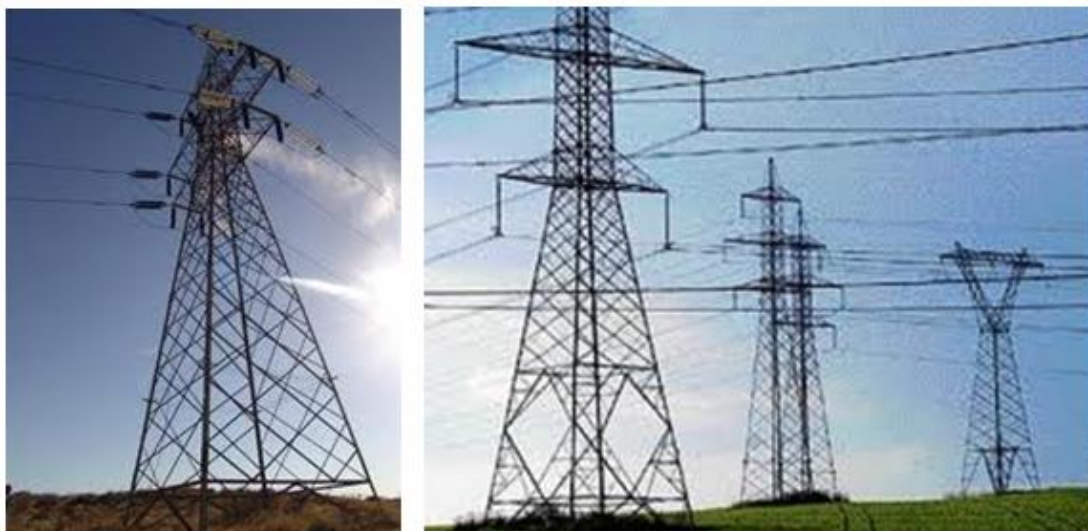
Σχήμα 1.7: Δικτυωτοί πυλώνες μεταφοράς ηλεκτρικής ενέργειας
