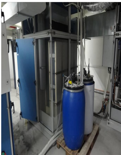
Εικόνα 21 Δεξαμενές Συγκέντρωσης Αφυγραντικού Υγρού
