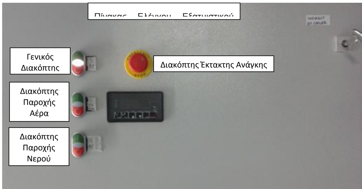
Εικόνα 18 Πίνακας Ελέγχου Εξατμιστικού Ψύκτη
