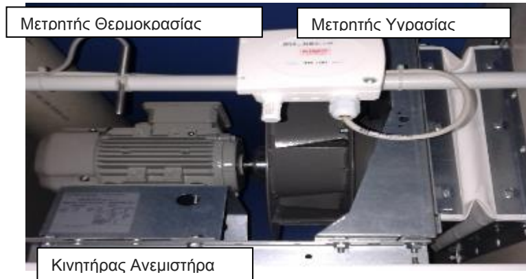
Εικόνα 12 Μετρήτης Πίεσης και Θερμοκρασίας και Ανεμιστήρας
