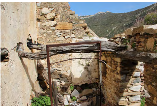
Εικ.66 Καταστροφή ξύλινου Φ.Ο. στέγασης βοηθητικών κτισμάτων
