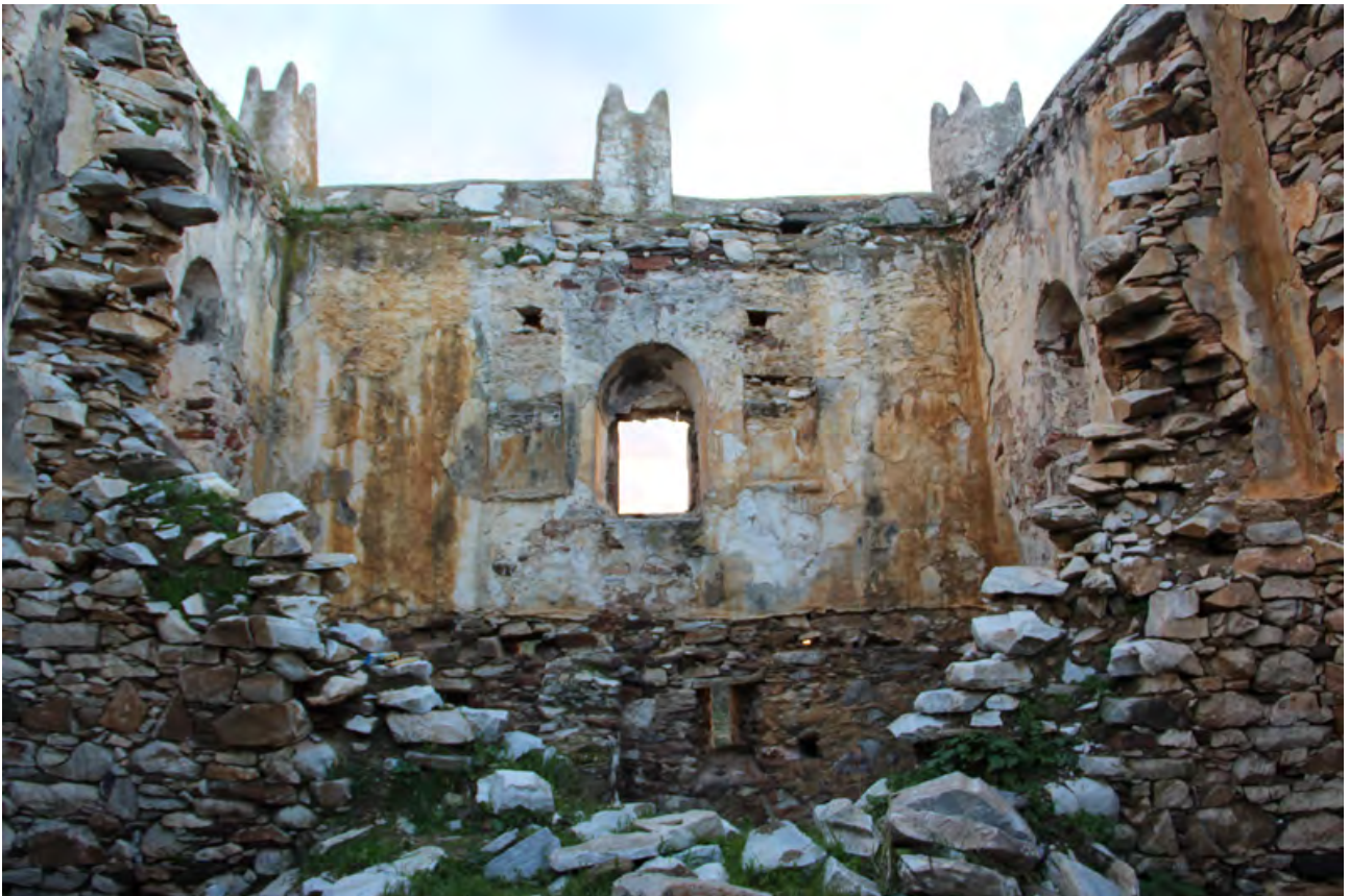
Εικ.63 Καταστροφή Φ.Ο. πατωμάτων Γ' Φάσης
