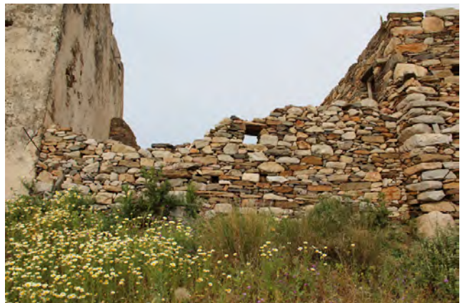
Εικ.98 Ο τοίχος της νοτιοανατολικής όψης του βοηθητικού κτίσματος μεταξύ πύργου και ελαιοτριβείου
