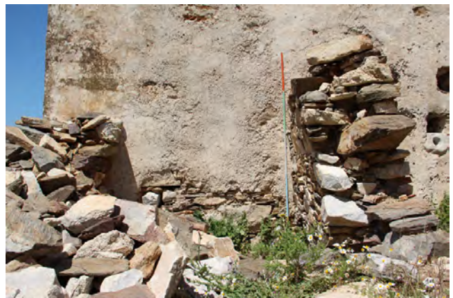
Εικ.67 Κατάρρευση τοιχοποιιών των βοηθητικών κτισμάτων
