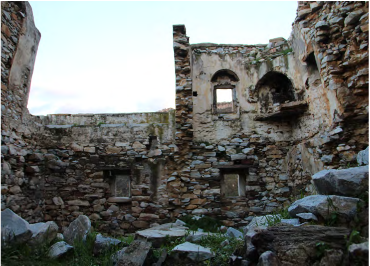
Εικ.61 Καταστροφή Φ.Ο. πατωμάτων Β' Φάσης
