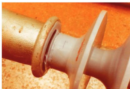
Σχήμα 1-13: Διάρρηξη της σφράγισης σε μονωτήρα της εταιρείας Rosenthal, στον οποίο έχει εφαρμοστεί η μέθοδος της σφήνας για σύνδεση ακροδεκτών-πυρήνα.[12]
