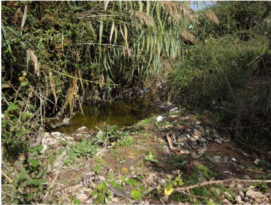
Εικόνα 3.2 Σημείο εκβολής αγωγού ομβρίων καλυμμένο από πυκνή βλάστηση
