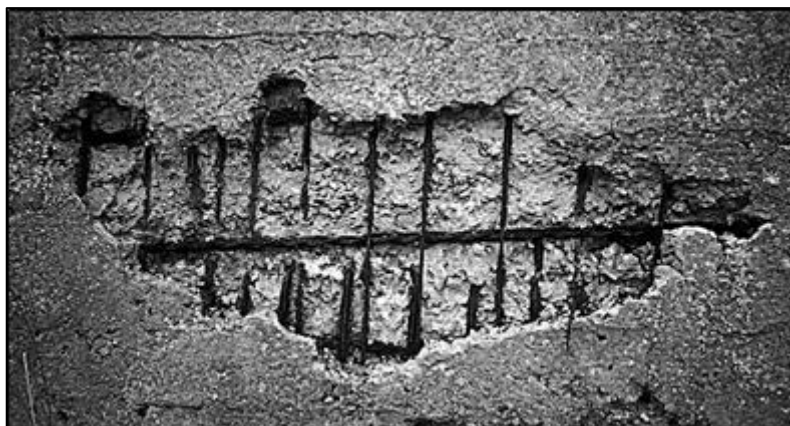
Σχήμα 4.7: Αποκόλληση σκυροδέματος εξαιτίας εφελκυστικών δυνάμεων που ασκούν τα προϊόντα διάβρωσης
