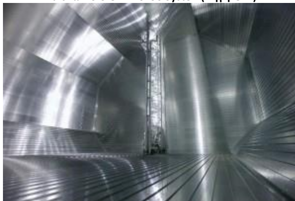
Εικόνα 1.5:9 Εσωτερικό δεξαμενής GTT No. 96 (Πηγή:GTT)
