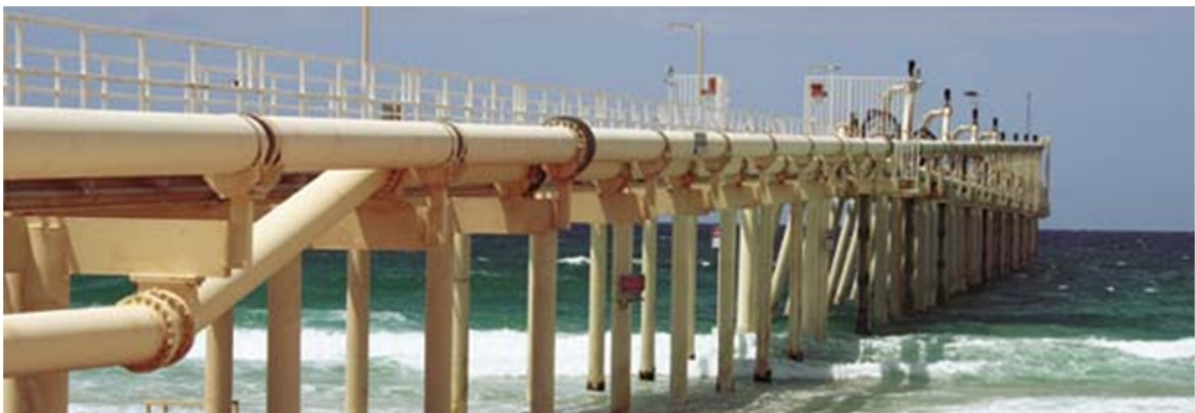
Εικόνα 3.7 Αγωγός μεταφοράς ιζήματος σε σύστημα sand by-pass στο Tweed River της Αυστραλίας ( www.tweedsandbypass.nsw.gov.au )
