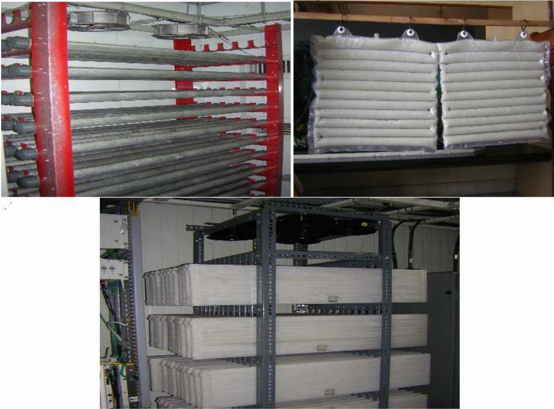
Εικόνα 9.8.8.1 Συσκευασίες PCM (πλάκες και κύλινδροι) που χρησιμοποιούνται σε τηλεπικοινωνιακά κουβούκλια. [90]
