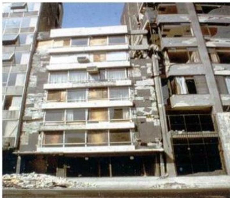
Σχήμα 1.2 Μεξικό 1985- Κρούση λόγω σεισμού όμορων κτιρίων με βλάβες
