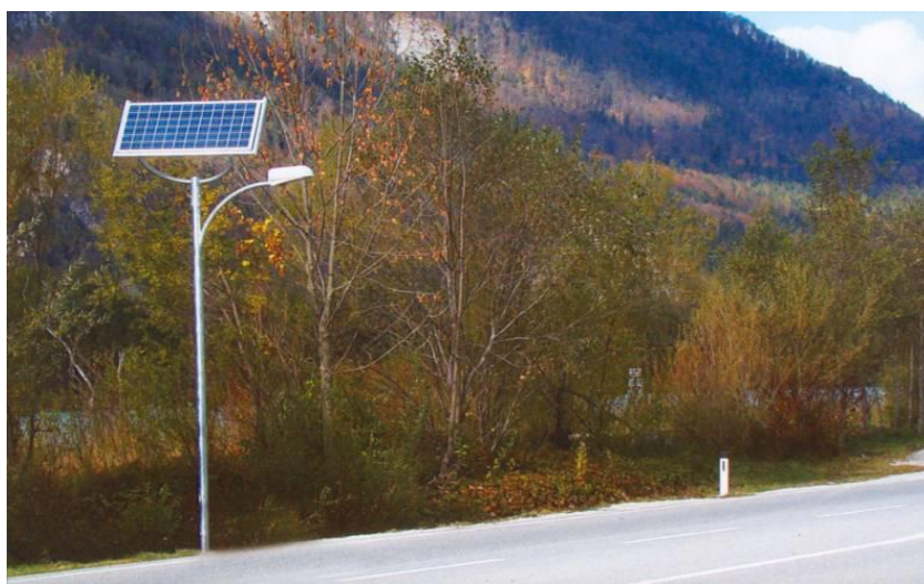
Εικόνα 5.10: Φωτιστικό με φωτοβολταϊκό πλαίσιο
