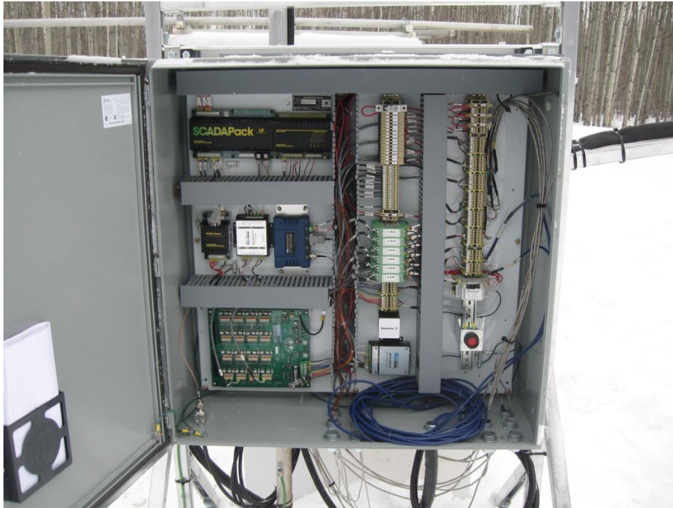
Σχήμα 2. 6 Εσωτερική εγκατάσταση RTU
