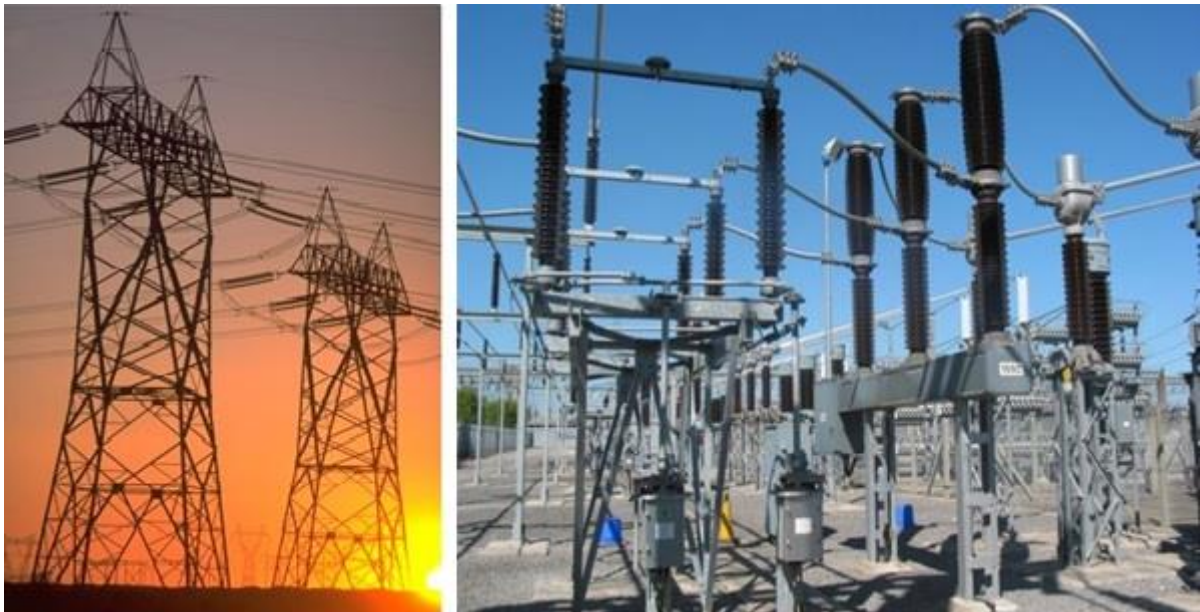
Σχήμα 1. 1 Γραμμές ΥΤ και Υποσταθμός Μεταφοράς ΥΤ
