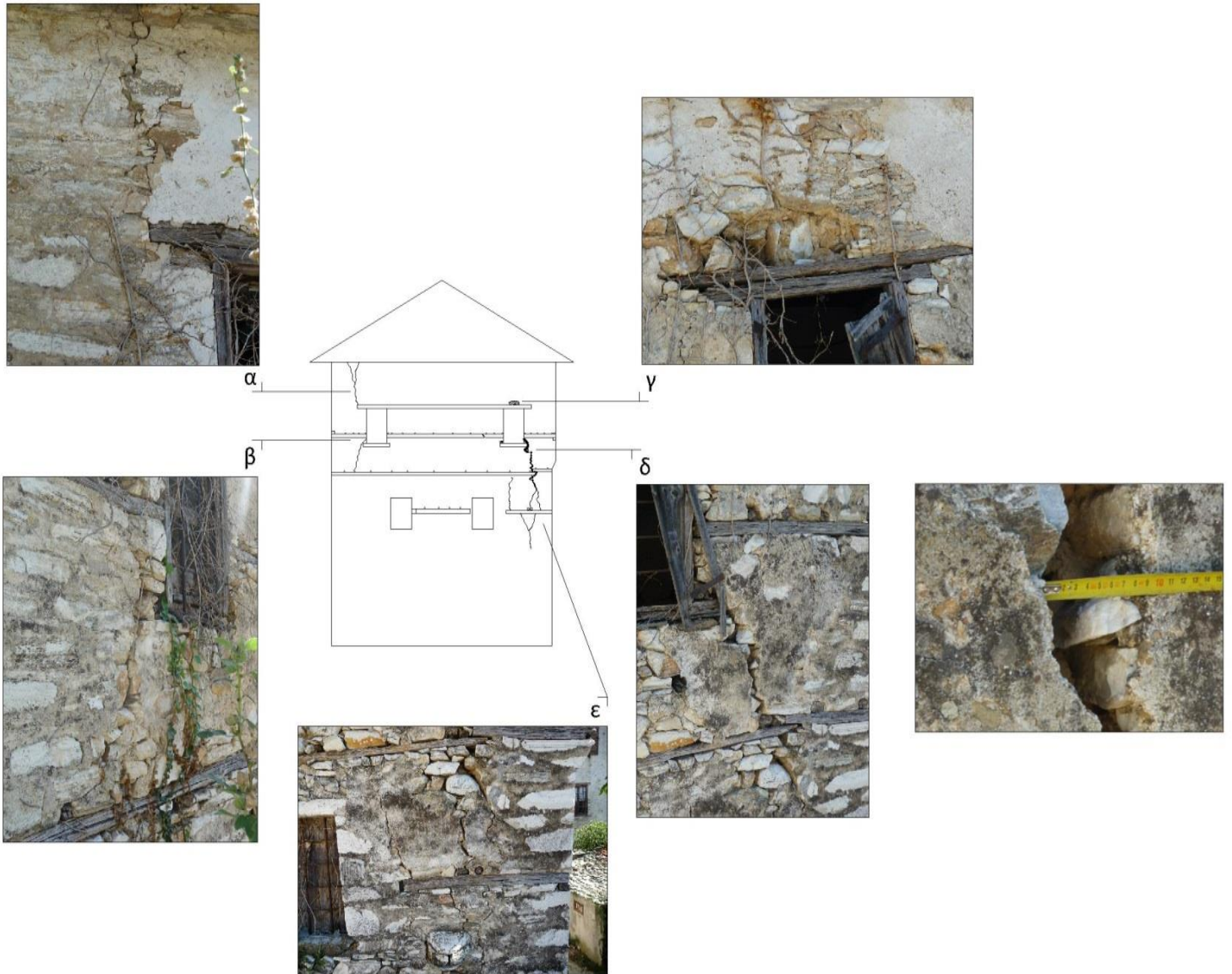
Σχ. 4.3.3 Παθολογία τοιχοποιίας στη δυτική πλευρά της οικίας στη σημερινή κατάσταση (α.κατακόρυφη ρωγή στο υπέρθυρο στην εξωτερική και εσωτερική παρειά του τοίχου, β.διαγώνια ρωγή στο κατώφλι στην εξωτερική και εσωτερική παρειά του τοίχου, γ.αποκόλληση λίθων και επιχρίσματος στο υπέρθυρο, δ.διαμπερής διαγώνια ρωγή στο κατώφλι ανοίγματος 6-8cm, ε.κατακόρυφες ρωγμές στην εξωτερική παρειά του τοίχου)
