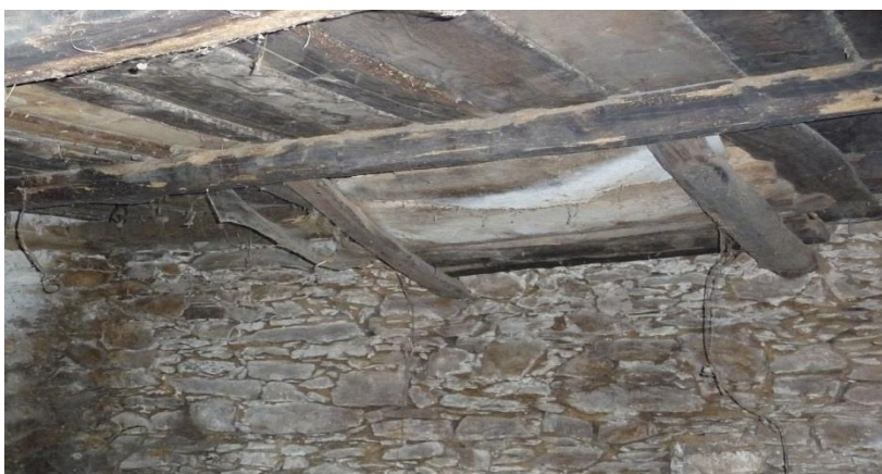
Σχ. 4.2.2 Μερική κατάρρευση οροφής
