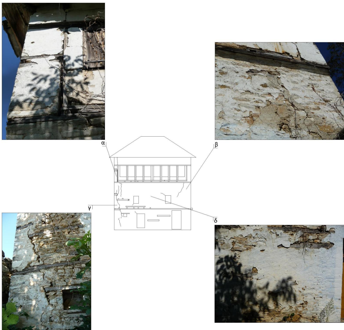
Σχ. 4.3.4 Παθολογία τοιχοποιίας στη νότια πλευρά της οικίας στη σημερινή κατάσταση (α.κατκόρυφη ρωγμή καθ' ύψος του δευτέρου ορόφου και ολική αποκόλληση του δυτικού τοίχου, β.διαγώνια ρωγμή και μεταγενέστερη επικάλυψη με ασβεστοκονίαμα, γ.κατακόρυφη ρωγμή καθ' ύψος του τοίχου, δ.μεταγενέστερο απαλειφόμενο επίχρισμα και ασβεστοκονίαμα για επιφανειακή κάλυψη φθορών)
