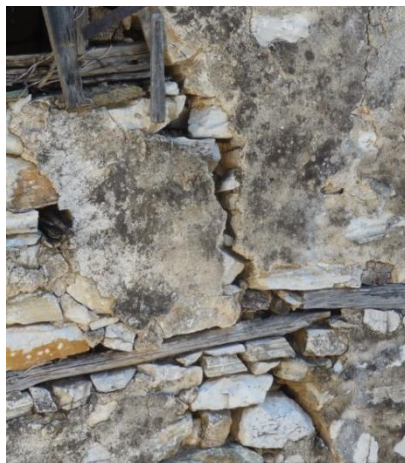
Σχ. 6.2.2 Ρωγμή που περνά μέσω της ασυνέχειας των ξύλων
