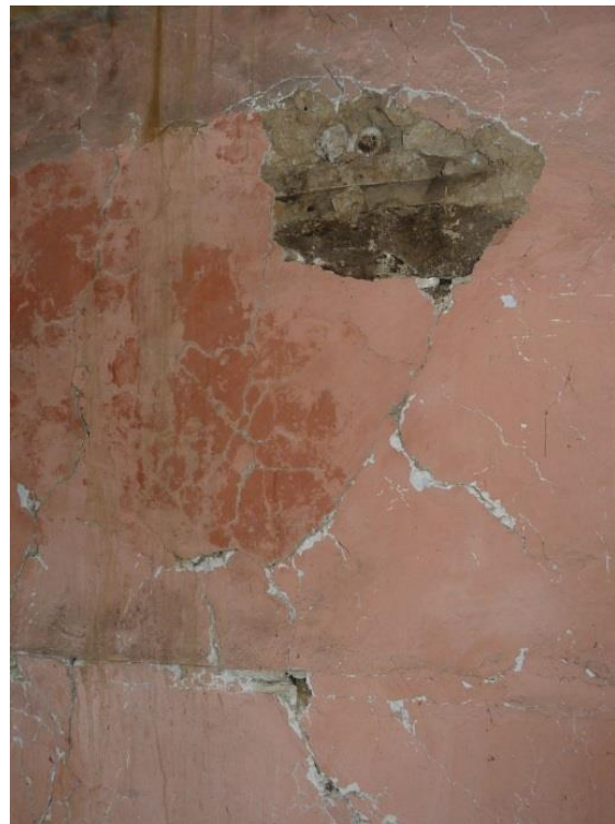
Σχ. 4.3.10 Αποκόλληση επιχρίματος
