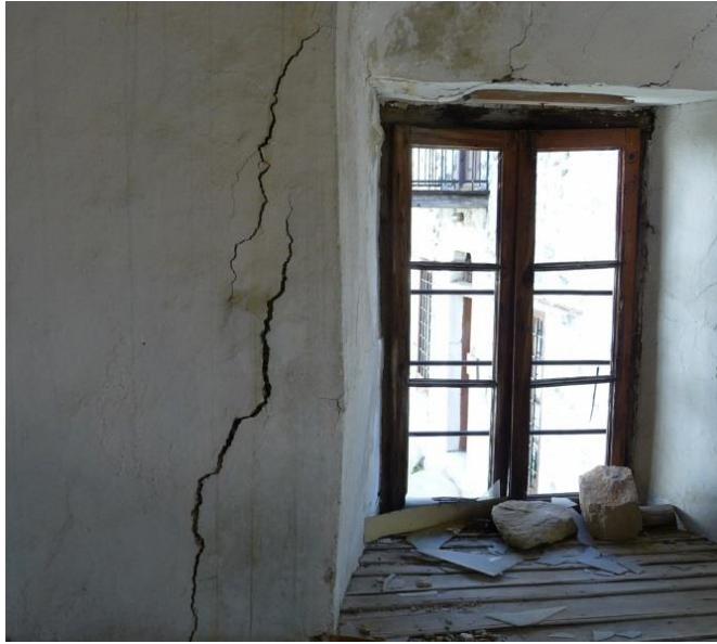
Σχ. 4.3.9 Ρηγμάτωση επιχρίματος
