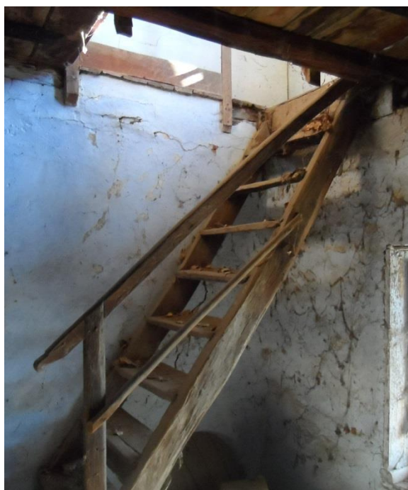
Σχ. 4.2.3 Εμφανής η γήρανση του ξύλου στη σκάλα του πρώτου ορόφου της δυτική μεριάς
