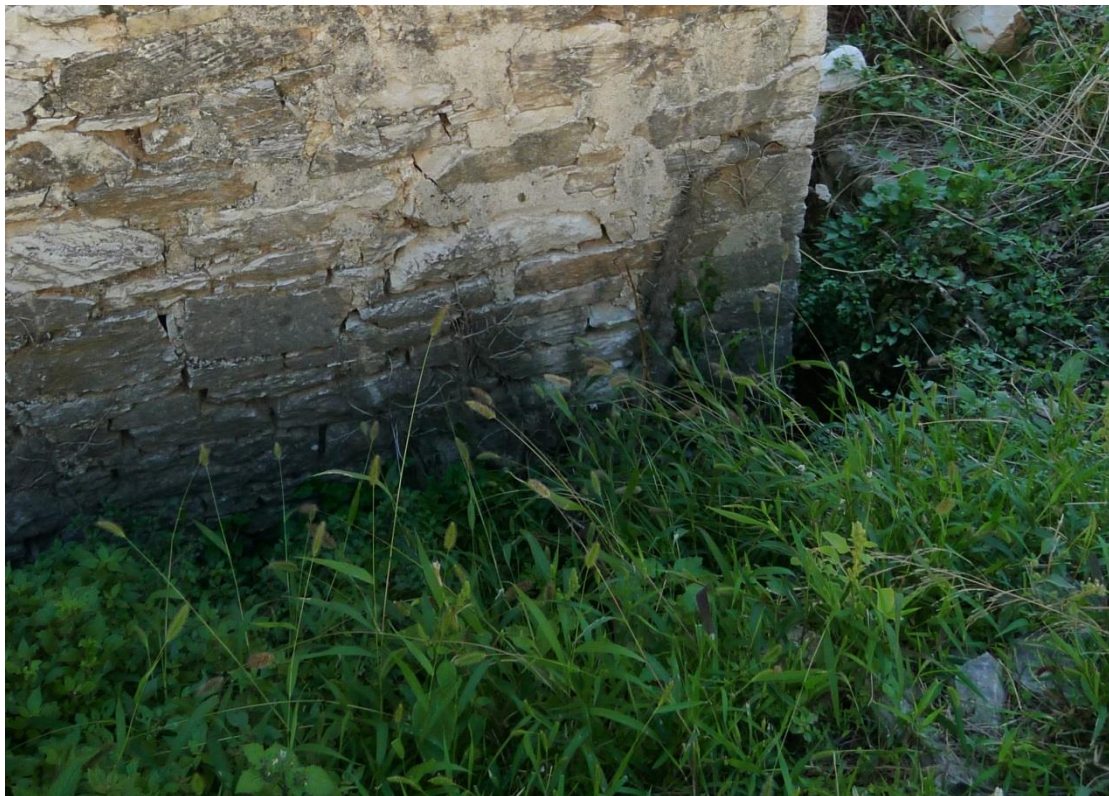
Σχ. 4.3.6 Εμφανής η διάβρωση της τοιχοποιίας του ισογείου στη βόρεια όψη
