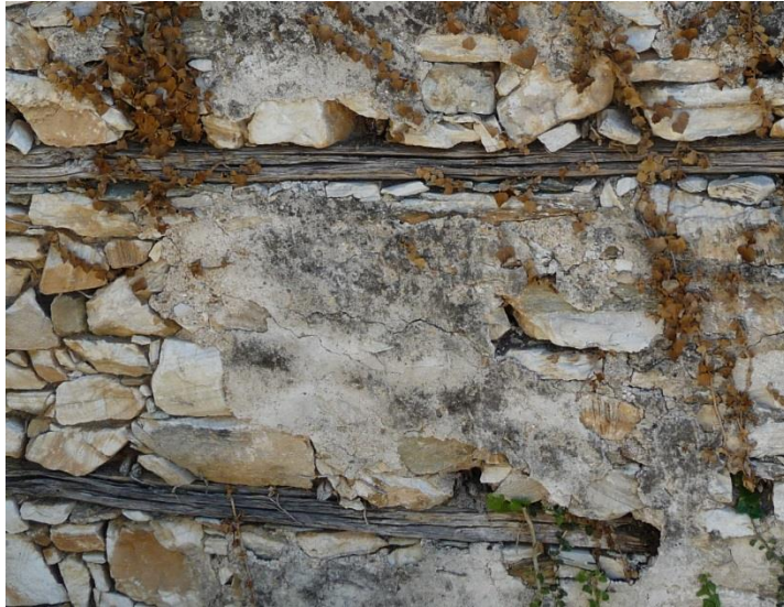
Σχ. 4.3.7 Φθορά επιχρίσματος
