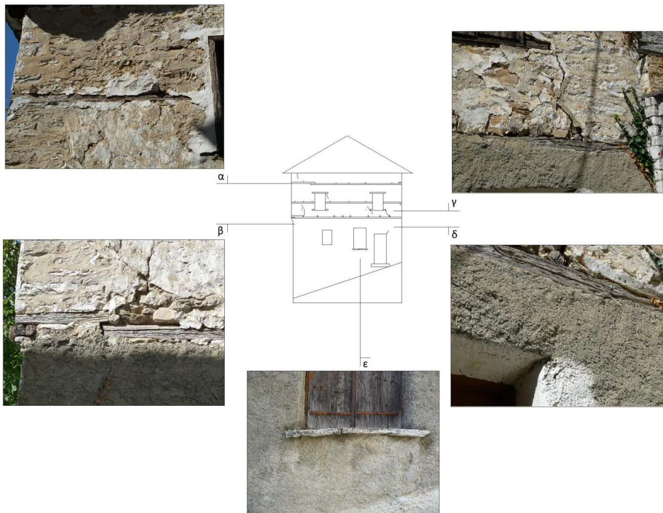
Σχ. 4.3.1 Παθολογία τοιχοποιίας στην ανατολική πλευρά της οικίας στη σημερινή κατάσταση (α.φθορά επιχρίσματος και επιφανειακές ρηγματώσεις- γεμίματα αρμών, β.ρηγμάτωση στην εξωτερική παρειά του τοίχου, γ.ρηγμάτωση στην εξωτερική παρειά του τοίχου, δ.εκτοξευόμενο επίχρισμα με επιφανειακές ρηγματώσεις, ε.σπασμένο πρεβάζι λόγω πιθανής ρηγμάτωσης του τοίχου)
