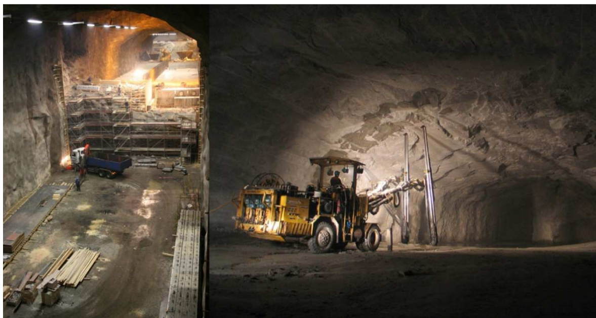
Εικόνα 2.2. Υπόγειες εγκαταστάσεις βιολογικού καθαρισμού λυμάτων στην Φινλανδία.
