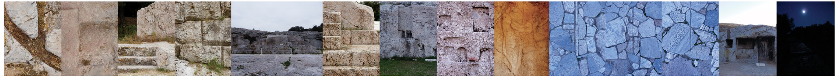
ΛΑΞΕΥΤΗ ΛΕΠΤΟΜΕΡΕΙΑ ΚΑΤΩ ΑΠΟ ΤΟ ΔΑΠΕΔΟ ΤΗΣ ΔΥΤΙΚΗΣ ΣΤΟΑΣ ΛΑΞΕΥΜΕΝΟΣ ΦΥΣΙΚΟΣ ΒΡΑΧΟΣ ΓΙΑ ΘΕΜΕΛΙΩΣΗ ΒΑ ΓΩΝΙΑΣ ΔΥΤΙΚΗΣ ΣΤΟΑΣ ΚΛΙΜΑΚΑ ΑΝΟΔΟΥ ΑΠΟ ΤΟ ΚΟΙΛΟ ΤΗΣ ΕΚΚΛΗΣΙΑΣ ΤΟΥ ΔΗΜΟΥ ΣΤΙΣ ΣΤΟΕΣ ΜΝΗΜΕΙΩΔΗΣ ΑΝΑΛΗΜΜΑΤΙΚΟΣ ΤΟΙΧΟΣ Γ' ΦΑΣΗΣ ΠΝΥΚΑΣ ΒΗΜΑ ΡΗΤΟΡΟΣ Γ' ΦΑΣΗΣ ΠΝΥΚΑΣ ΙΕΡΟ ΥΨΙΣΤΟΥ ΔΙΟΣ ΚΟΓΧΕΣ ΑΝΑΘΗΜΑΤΩΝ ΙΕΡΟΥ ΥΨΙΣΤΟΥ ΔΙΟΣ ΑΝΑΓΛΥΦΗ ΠΑΡΑΣΤΑΣΗ ΙΕΡΟΥ ΠΑΝΟΣ ΔΙΟΙΚΟΝΤΕΣ ΑΡΜΟΙ ΠΟΛΙΤΙΚΗΣ ΟΡΑΣΗΣ ΘΕΑΣΗ ΑΚΡΟΠΟΛΗ ΑΠΟ ΑΝΔΗΡΟ ΠΙΚΙΩΝΗ ΗΡΩ ΠΟΙΗΤΗ ΜΟΥΣΑΙΟΥ ΛΙΘΟΣΤΡΩΤΟ ΠΙΚΙΩΝΗ ΠΡΟΣ ΚΟΡΥΦΗ ΛΟΦΟΥ ΜΟΥΣΩΝ
