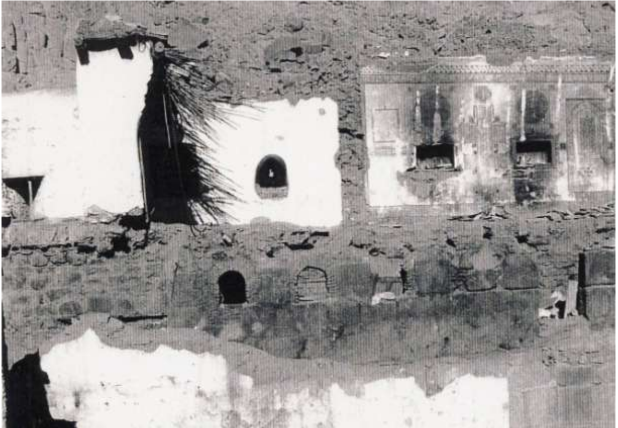
Εικ.334. Παρεκκλήσιο Αγίου Γεωργίου. Η βόρεια εσωτερική όψη μετά την πυρκαγιά του 1971. Αρχείο ΔΑΒΜΜ, ΥΠΠΟ.
