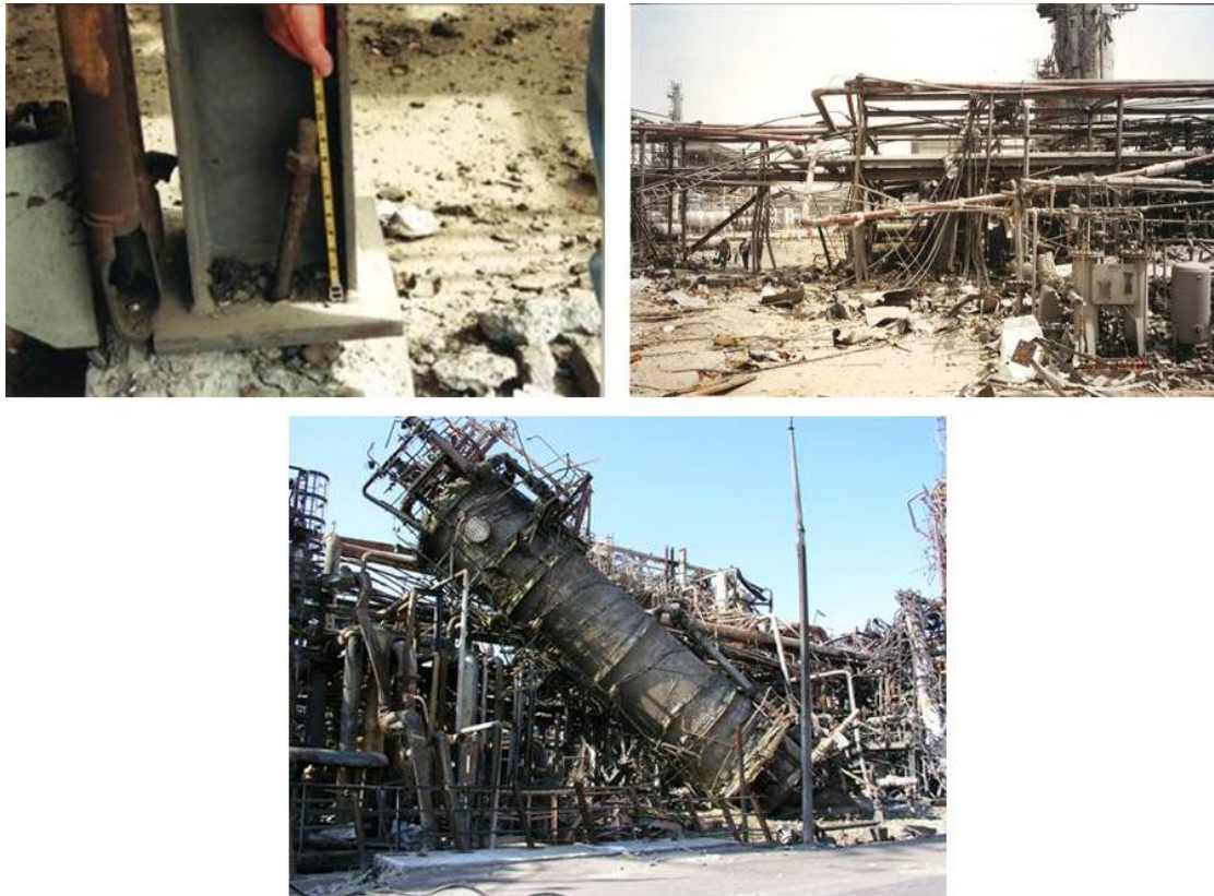
Εικόνα 2.6: Αστοχία θεμελίωσης μεταλλικού φορέα υποστήριξης σωληνώσεων (πάνω αριστερά), αστοχία σωληνώσεων παρόλο που ο φορέας υποστήριξης δεν έχει καταρρεύσει (πάνω δεξιά), αστοχία γειτονικής κατασκευής η οποία έπεσε σε φορέα υποστήριξης (κάτω).
