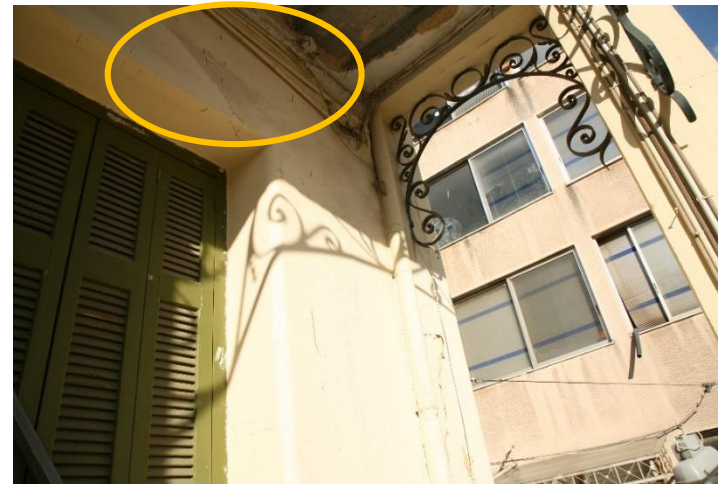
Εικόνα 9: Φούσκωμα στο υπέρθυρο του α' ορόφου.
