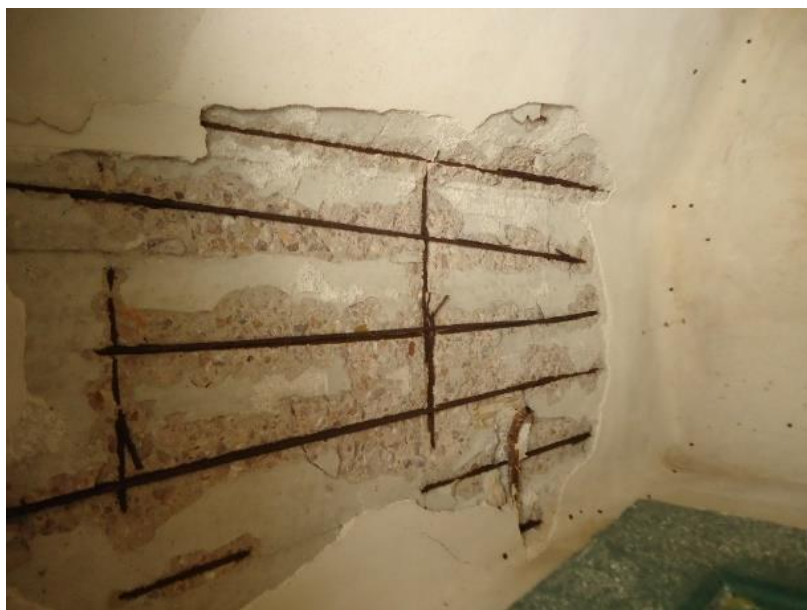
Εικόνα 7: Διαβρωμένος οπλισμός σκάλας
