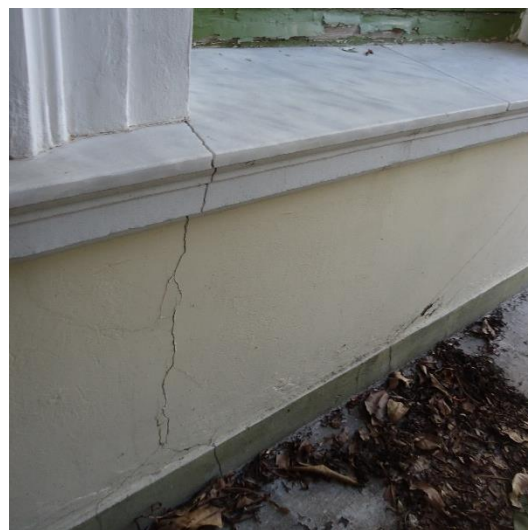
Εικόνα 13: Σχεδόν κατακόρυφες ρωγμές στις γωνίες των ανοιγμάτων.
