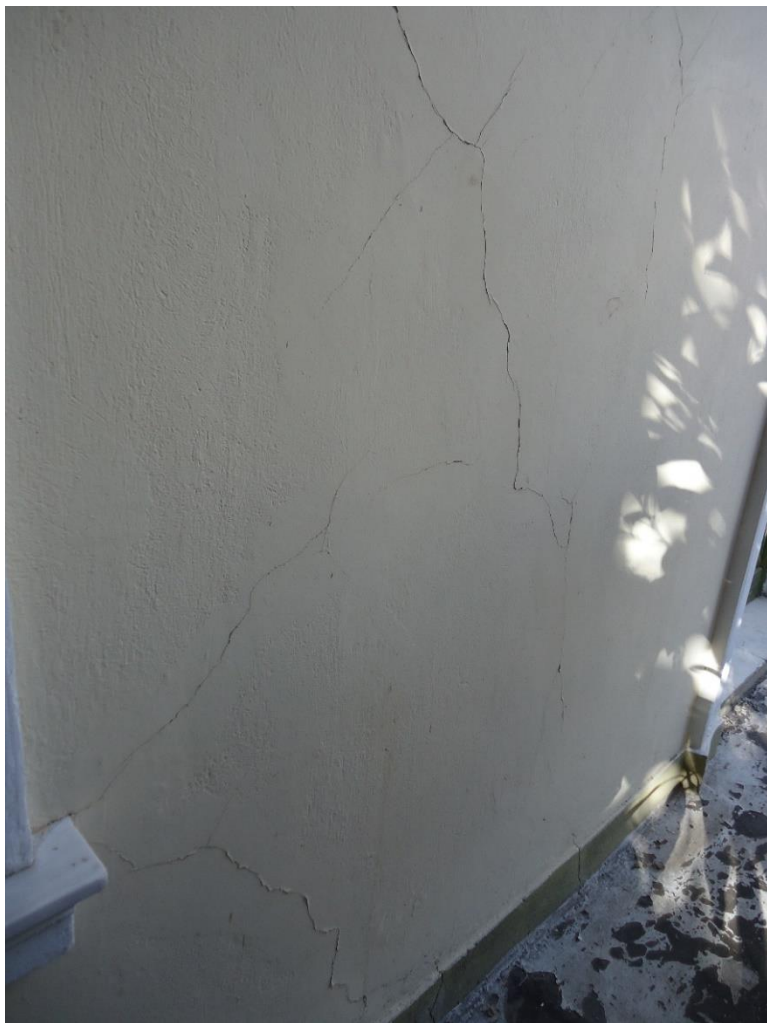
Εικόνα 12: Χιαστί ρωγμές λόγω διατμητικής αστοχίας σε πεσσό του β' ορόφου.
