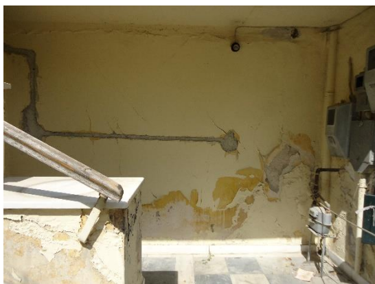
Εικόνα 22: Υγρασία και φθορές λόγω ηλεκτρολογικών εγκαταστάσεων.
