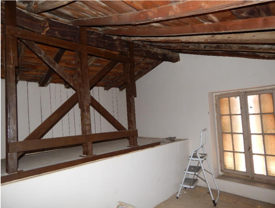
Εικόνα 1: Στέγη οικίας- Εμφανές το βέλος κάμψης των δοκών της στέγης.
