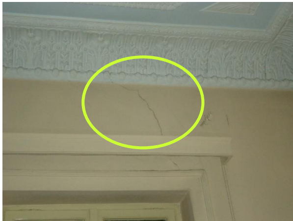
Εικόνα 10: Σχεδόν κατακόρυφες ρωγμές στις γωνίες των ανοιγμάτων.
