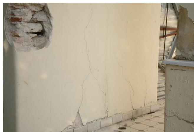
Εικόνα 14: Λοξές και κατακόρυφες ρωγμές λόγω σεισμικής δράσης σε πεσσό του α' ορόφου.
