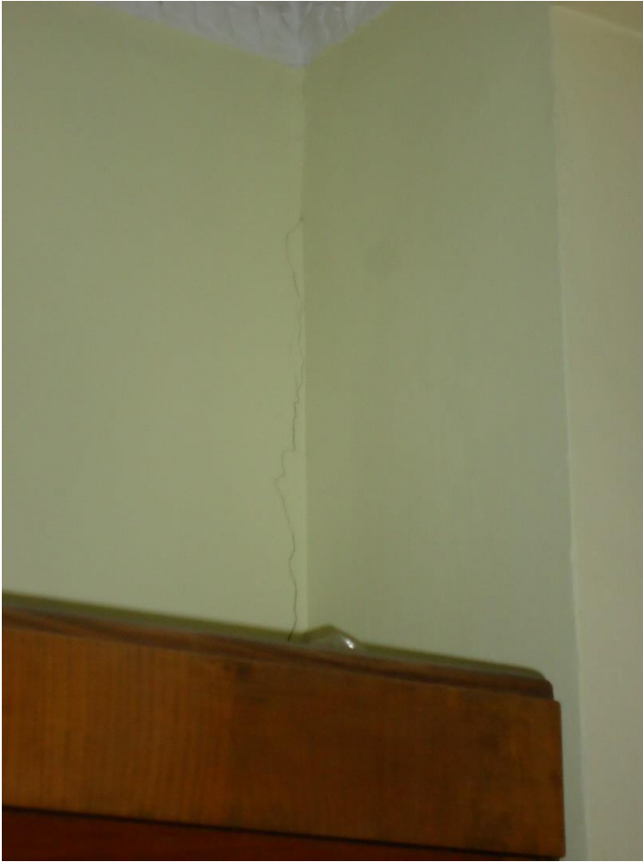
Εικόνα 15: Κατακόρυφη ρωγμή στη σύνδεση εγκάρσιων τοίχων. (κακή συνεργασία)
