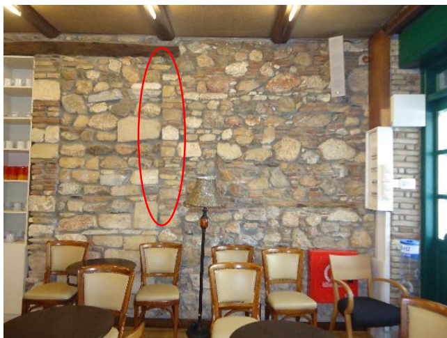
Εικόνα 62: Ασυνέχεια τοιχοποιίας στο χώρο του ισογείου της οικίας Δουρούτη
