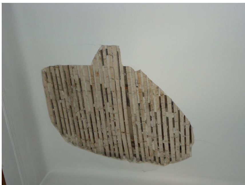
Εικόνα 4: Κατάρρευση τμήματος της οροφής του α' ορόφου.
