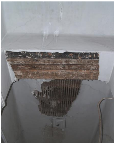
Εικόνα 55: Ξύλινο δοκάρι σε διπλανό κτίριο( Αρχείο Δήμου Αθηναίων)
