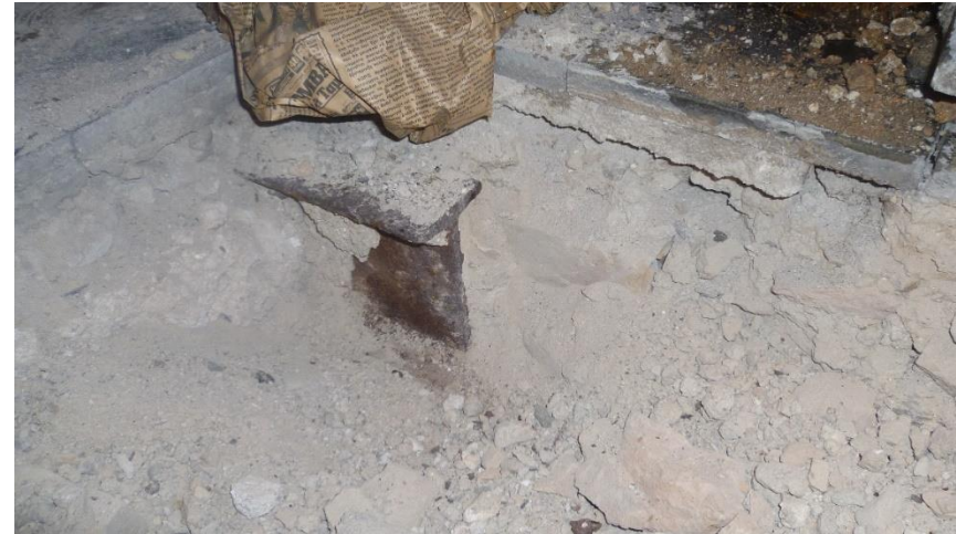
Εικόνα 50: Μεταλλική δοκός πατώματος οικίας Δουρούτη
