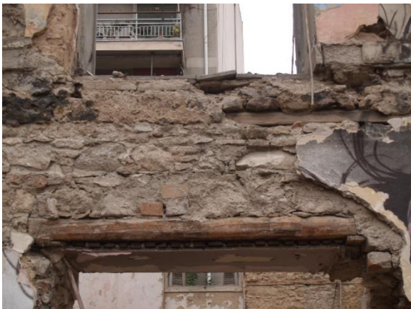
Εικόνα 58: Ξυλοδεσιά στο πάνω και στο κάτω μέρος των ανοιγμάτων- Συγκρότημα Μεταξουργείου (Αρχείο Δήμου Αθηναίων)
