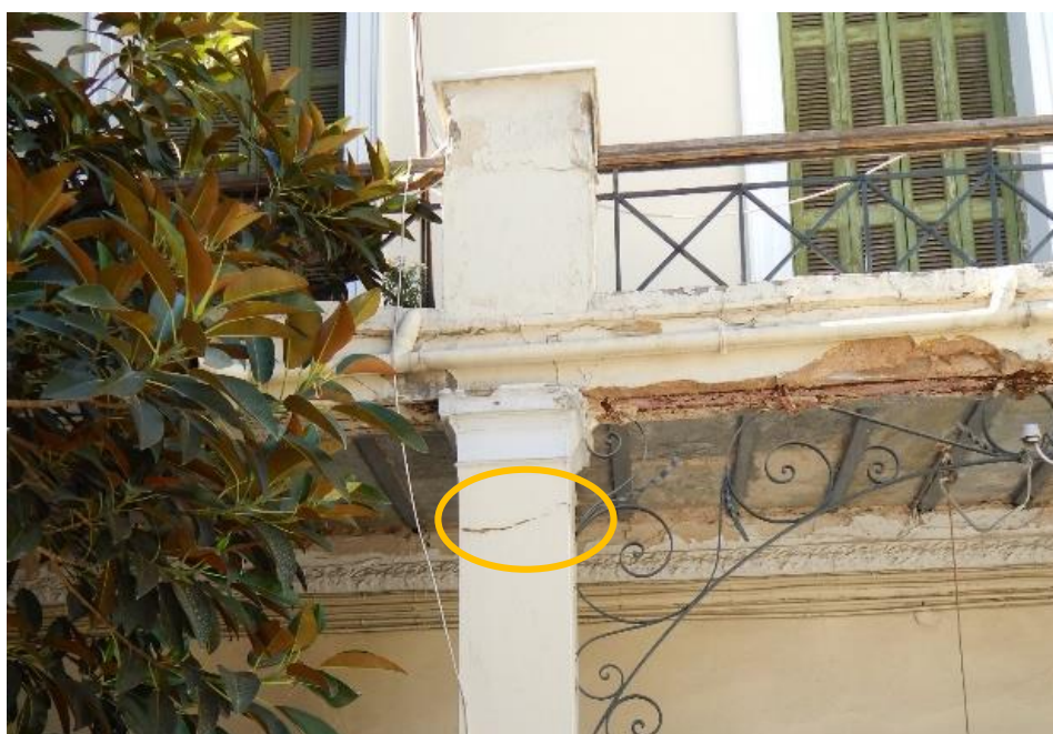
Εικόνα 18: Οριζόντια ρωγή υποστύλματος.
