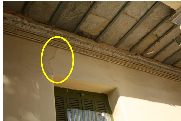
Εικόνα 11: Σχεδόν κατακόρυφες ρωγμές στις γωνίες των ανοιγμάτων.
