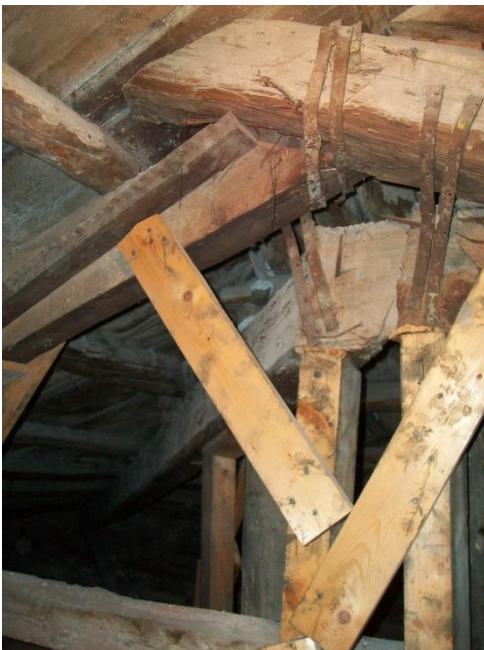
Εικόνα 2: Διάβρωση συνδετικών στοιχείων.
