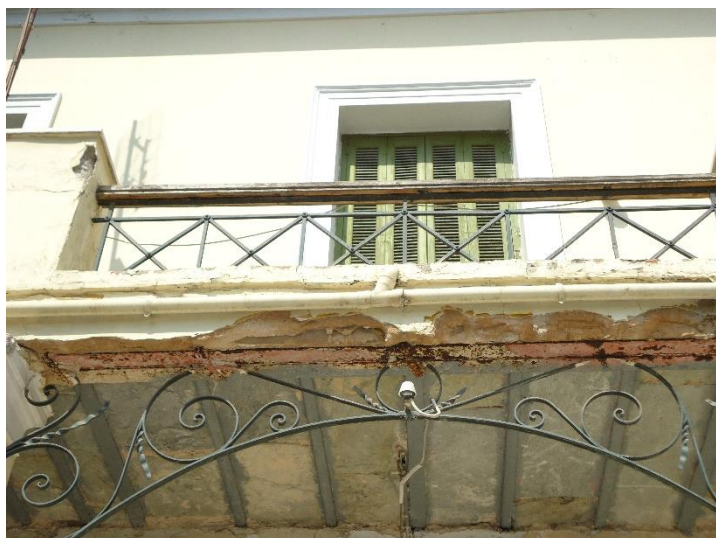
Εικόνα 3: Μεταλλικές δοκοί διπλού ταν διαβρωμένες.
