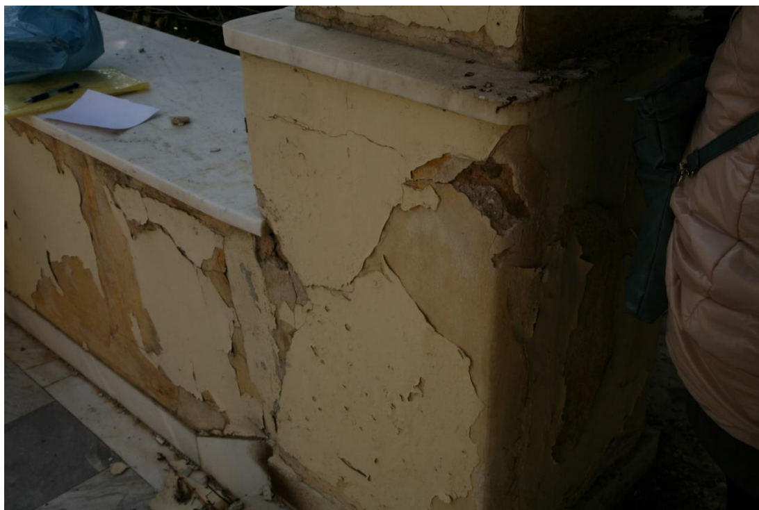
Εικόνα 17: Φθορές επιχρίσματος και ρωγμές οριζόντιες και κατακόρυφες.
