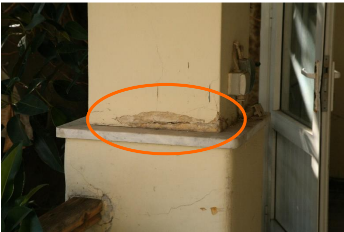
Εικόνα 16: Οριζόντιες ρωγμές ενός εξωτερικού υποστυλώματος.
