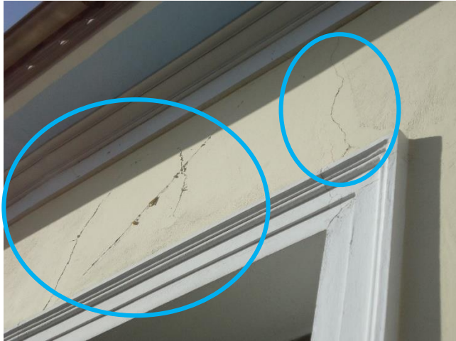
Εικόνα 8: Χιαστί ρωγμές σε υπέρθυρο του β' ορόφου λόγω διαμητικής αστοχίας.
