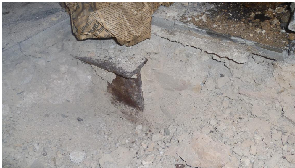
Εικόνα 5: Διάβρωση μεταλλικής δοκού πατώματος.
