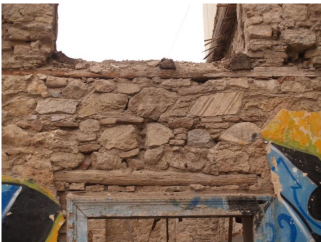
Εικόνα 60: Ξυλοδεσιά στο πάνω και στο κάτω μέρος των ανοιγμάτων- Συγκρότημα Μεταξουργείου (Αρχείο Δήμου Αθηναίων)
