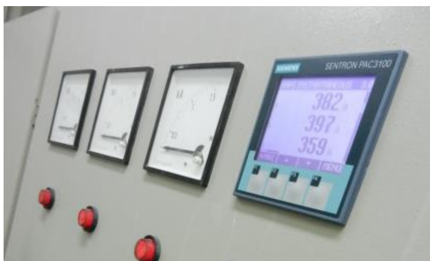
Εικόνα 7.4:5 Εγκατεστημένος μετρητής θύρας PAC3100
