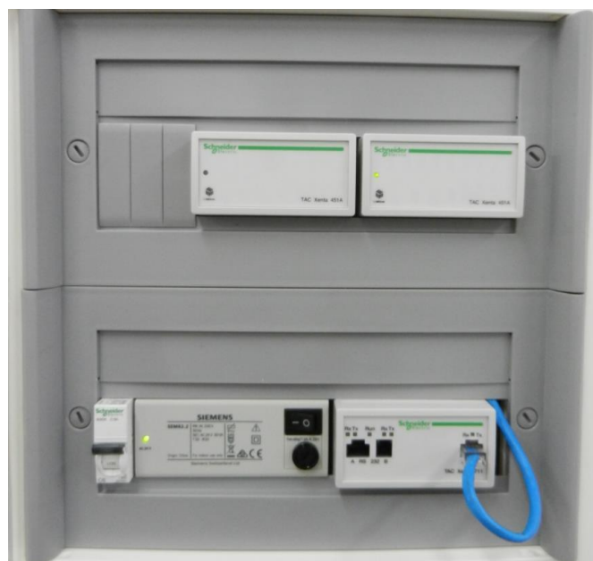
Εικόνα 7.7:2 Εγκατεστημένος ελεγκτής Xenta711 μαζί με I/O modules Xenta451A
