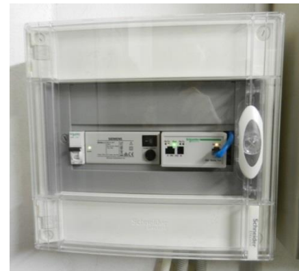
Εικόνα 7.7:1 Εγκατεστημένος ελεγκτής Xenta 701
