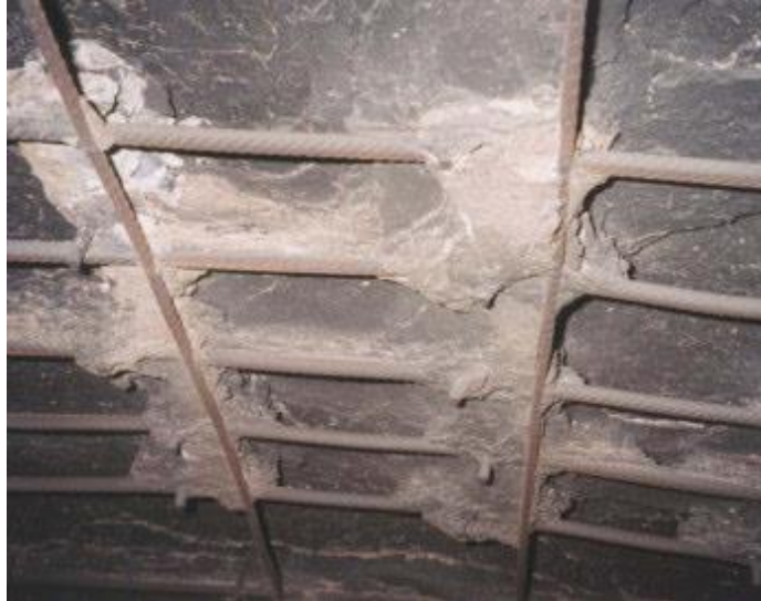
Εικόνα 3.7: Αποφλοίωση του σκυροδέματος μετά από πυρκαγιά. [Αγγελόπουλος et al,2005]
