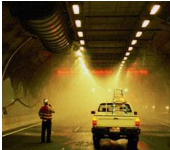
Εικόνα 3.10: Σύστημα ψεκασμού νερού [www.ultrafog.com]
