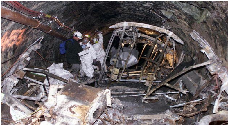
Εικόνα 1.4: Εικόνα μετά από την πυρκαγιά στη σήραγγα του Καπρούν [FireVu,2014]
