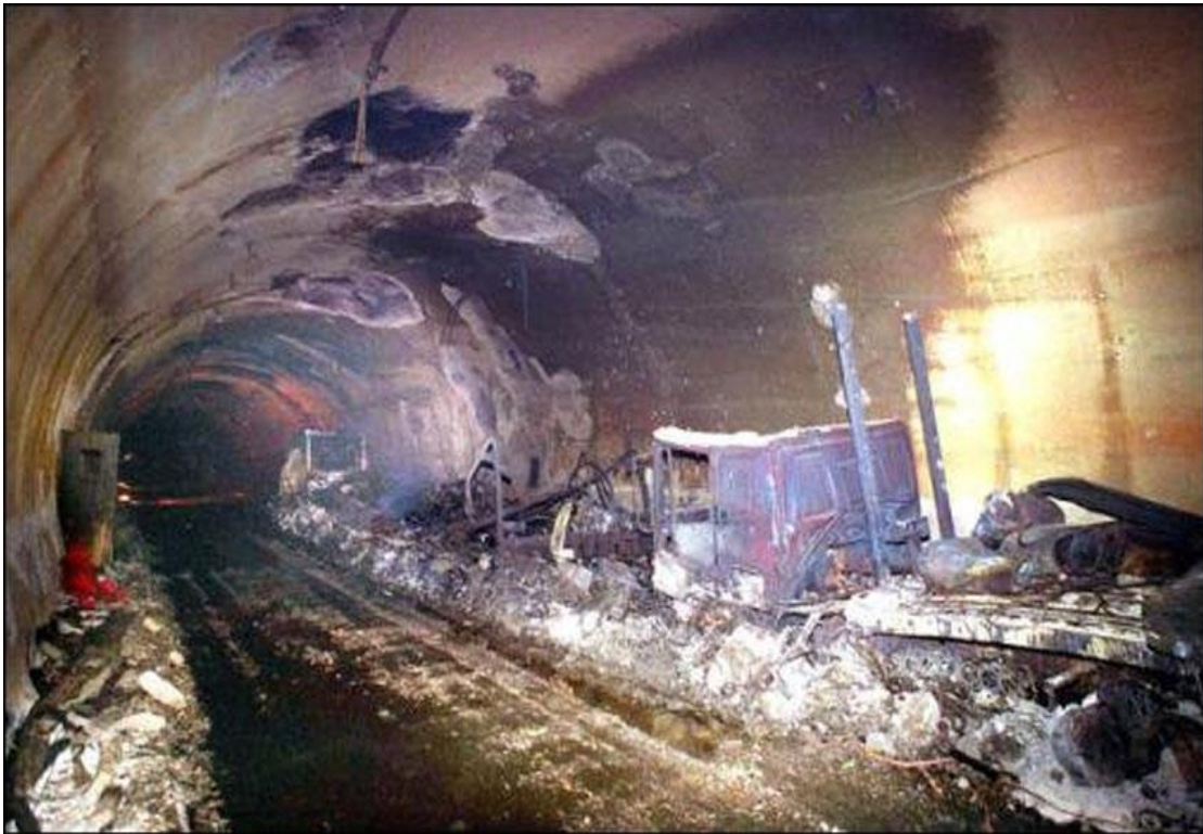
Εικόνα 1.2: Καταστροφή του σκυροδέματος της επένδυσης της σήραγγας του Mont Blanc [tunneltalk.com]
