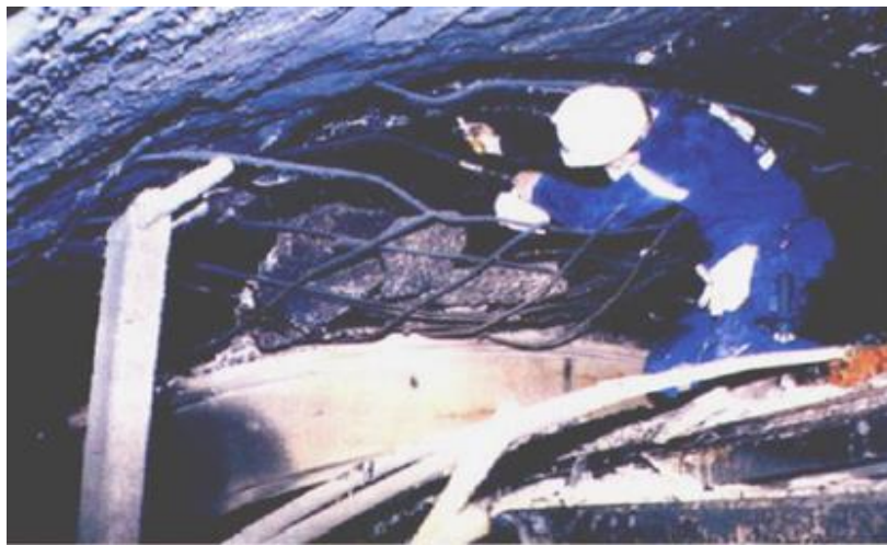
Εικόνα 3.1: Εικόνα καταστροφής της επένδυσης της σήραγγας Great Belt (Δανία 1994). [Αγγελόπουλος et al,2005]
