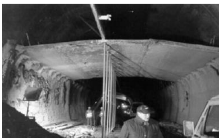
Εικόνα 3.23: Υποστήριξη της οροφής στα σημεία σύνδεσης με τα πλαϊνά τοιχώματα [Αγγελόπουλος et al,2005].
