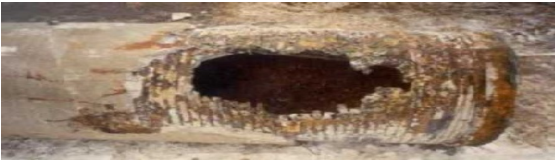
Σχήμα 1.6.1.3: Υπόγειος μεταλλικός σωλήνας νερού 36
