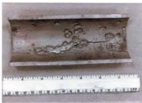
Σχήμα 1.3.3: Διάβρωση με βελονισμούς σε μεταλλικούς αγωγούς 41
