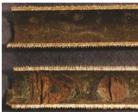
Σχήμα 1.3.12: Ρωγμές από διάβρωση λόγω κόπωσης σε ορειχάλκινο σωλήνα συμπύκνωσης νερού[57]
