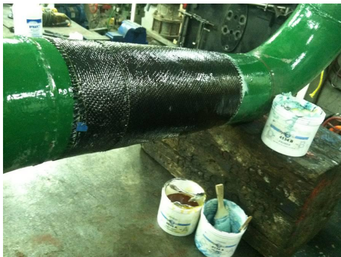
Σχήμα 1.1: Προσωρινή αποκατάσταση διαρροής σε δίκτυο θαλάσσης με επίπλαση με το χέρι (HLU) σύνθετου επιθέματος με ίνες άνθρακα (πηγή: www.marinelink.com ).
