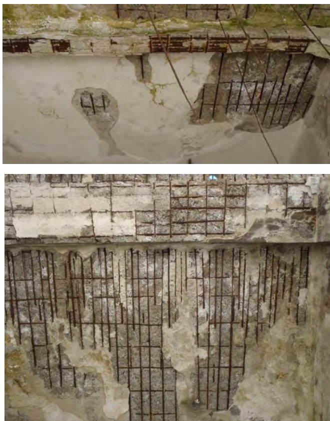
Σχήμα 3.42: Εκτεταμένες βλάβες σε δοκούς οροφής ισογείου
