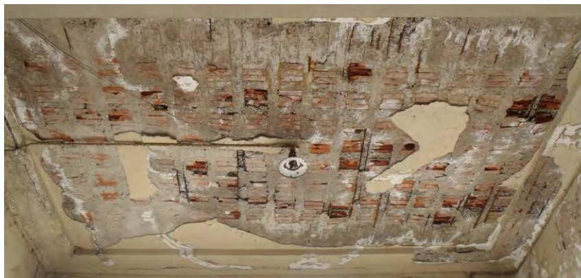
Σχήμα 3.22: Πλάκα Zoellner στην οροφή ισογείου καταστήματος στη γωνία των οδών Νεοφύτου και Κριεζώτου
