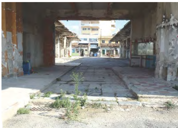
Σχήμα 3.47: Κεντρική είσοδος της δημοτικής αγοράς. Είναι εμφανής η καθίζηση του εδάφους στην περιοχή.
