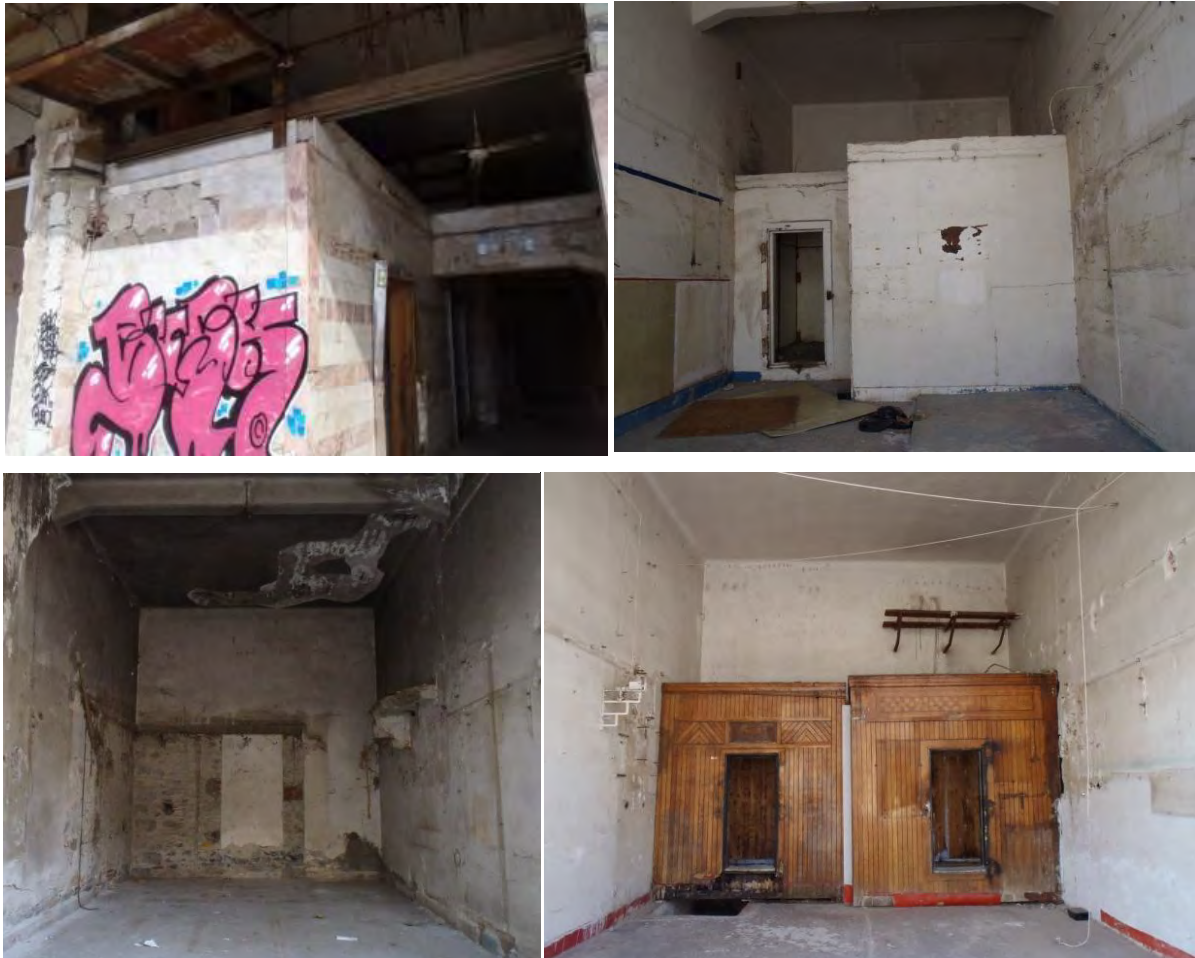
Σχήμα 3.13: Καταστήματα που έχουν υποστεί τροποποιήσεις (κατασκευές εσωτερικών χωρισμάτων, καθαιρέσεις παταριών)
