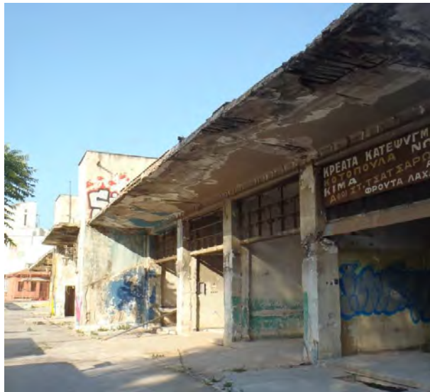
Σχήμα 3.7: Άποψη της μετωπικής πτέρυγας της β' φάσης της δημοτικής αγοράς. Διακρίνεται το κεντρικό τμήμα της καθώς και τα καταστήματα με τον περιμετρικό πρόβολο μπροστά και πάνω από την είσοδο τους
