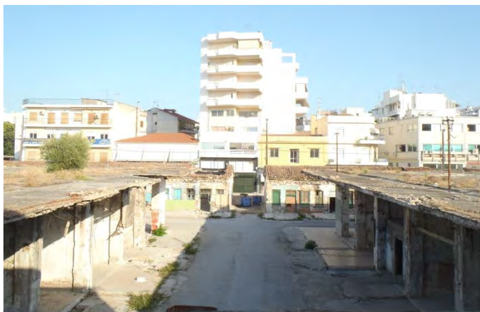
Σχήμα 2.68: Άποψη ορισμένων κτηρίων της δημοτικής αγοράς από τον πρώτο όροφο της δημοτικής αγοράς. Στο βάθος τα γειτονικά κτήρια της δημοτικής αγοράς
