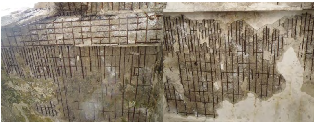
Σχήμα 3.35: Εκτεταμένες βλάβες της οροφής ισογείου. Αποκολλήσεις σκυροδέματος, έντονη οξείδωση των οπλισμών
