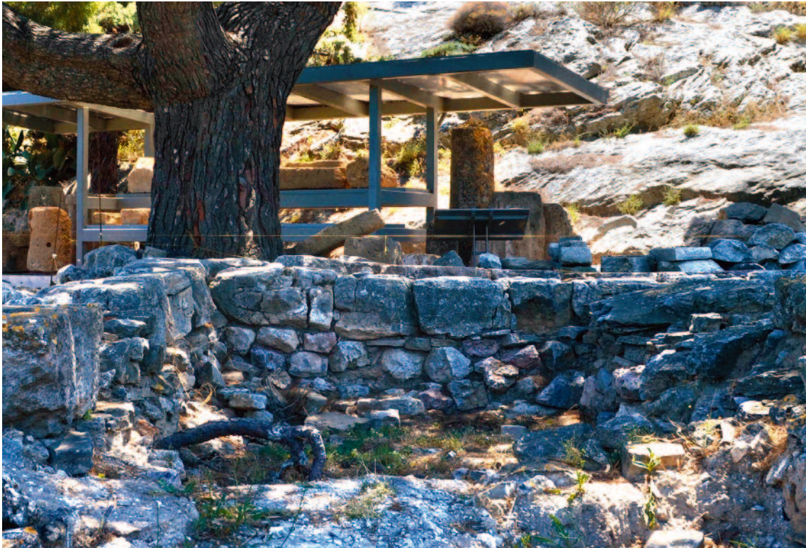
Εικ.35. Η θεμελίωση της νότιας πλευράς του προδόμου του ναού από τα βόρεια. Παρατηρείται η μετατόπιση της προς τα πάνω, λόγω του ριζικού συστήματος του πεύκου.
