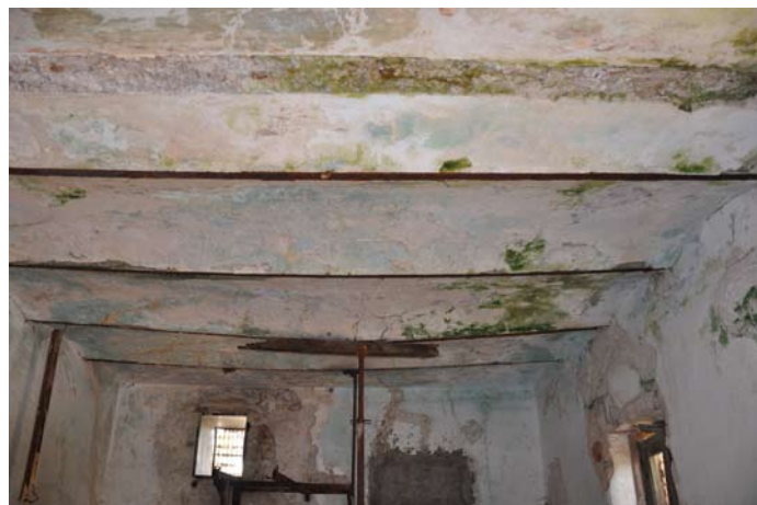
εικ.91 : κάμψη δοκών στο χώρο κ1.01 και υποστήλωσή τους
