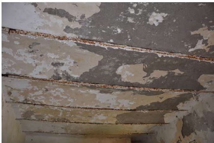
εικ.90 : οξειδωση σιδηροδοκών στο χώρο κ1.22
