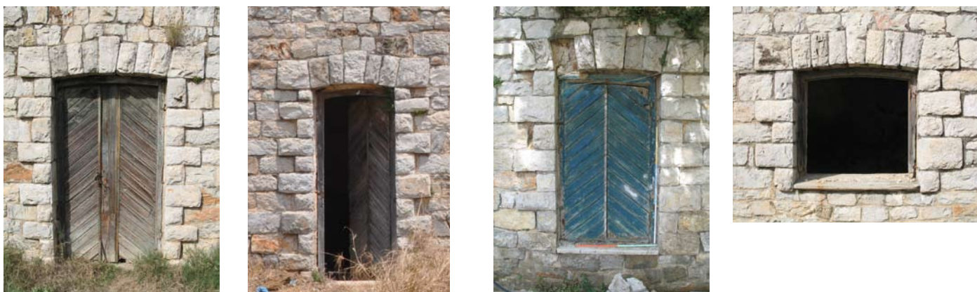
εικ. 32 έως 35 : οι τέσσερις τύποι των ανοιγμάτων στις ισόγειες πτέρυγες με τη σειρά που περιγράφονται παραπάνω
