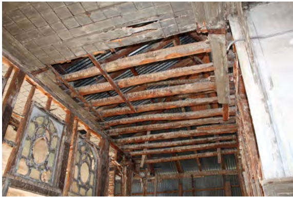
εικ.236 το κατεστραμμένο τμήμα της οροφής της μπασιάς
