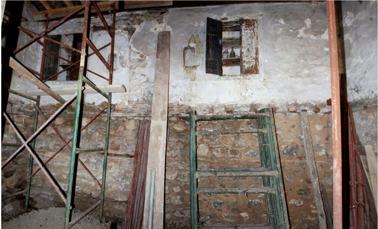
εικ.50, βόρειος τοίχος του δωματίου, διακρίνονται οι αποκομμένοι δοκοί
