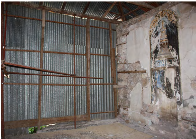
εικ.111, η κατεστραμμένη δυτική όψη του οντά
