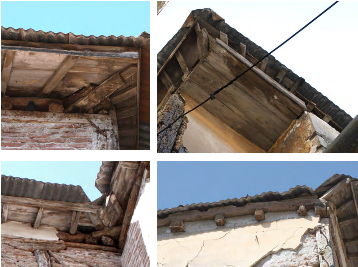
εικ.161-164, η σημερινή κατάσταση του γείσου του Αρχοντικού
