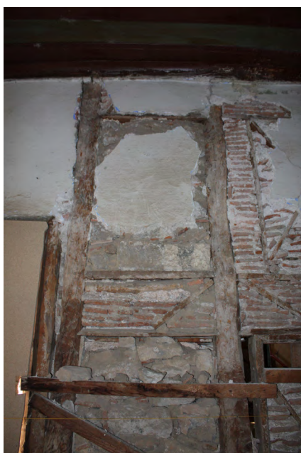
εικ.105, φραγμένο άνοιγμα στον ξυλόπηκτο τοίχο
