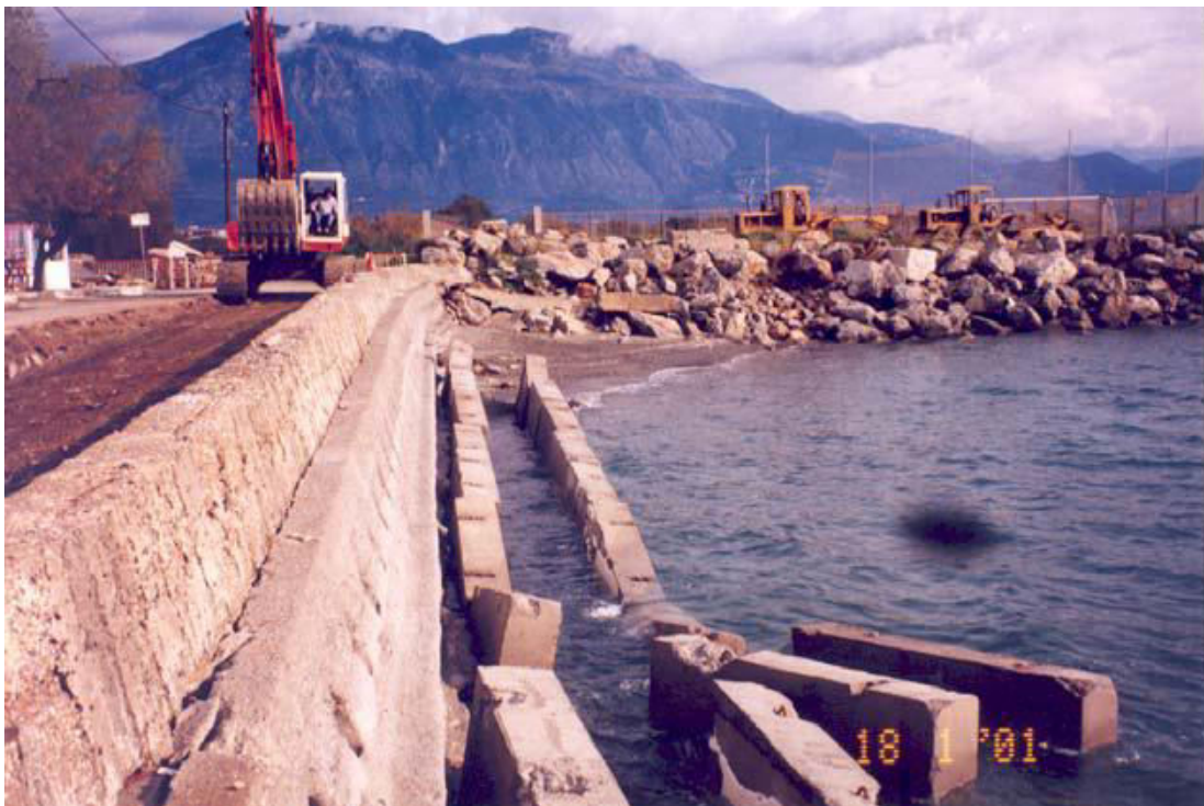
ΦΩΤΟ 2.7: ΔΙΑΒΡΩΣΗ ΛΟΓΩ ΚΑΤΑΚΟΡΥΦΟΥ ΤΟΙΧΟΥ
