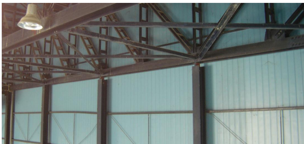
Φωτογραφία 2.6: Καθίζηση μετωπικών υποστυλωμάτων - Παραμορφώσεις μηκίδων
