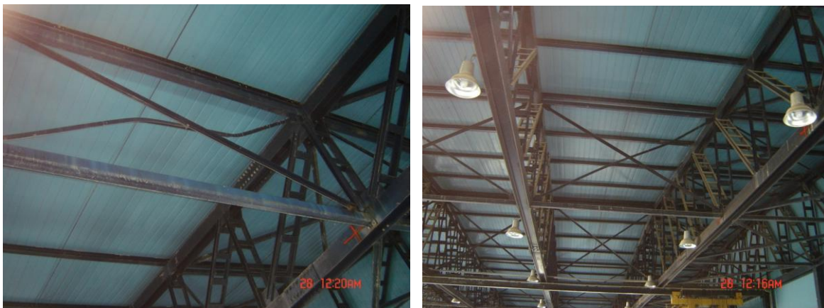
Φωτογραφίες 2.4 & 2.5: Βλάβες στους 1ο & 2ο εγκάρσιο σύνδεσμο δυσκαμψίας (πλησίον άκρου καθίζησης)
