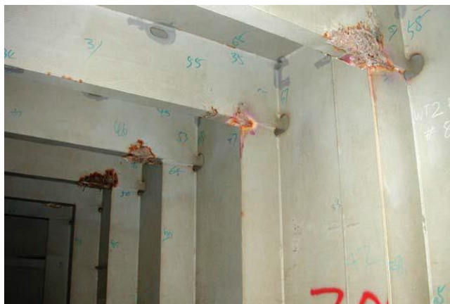
Εικόνα 30: Αστοχία επιστρωμάτων προκληθείσα από τάσεις [23]
