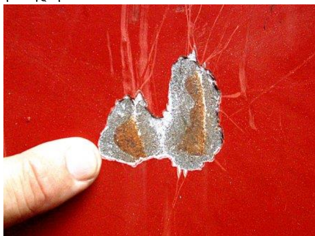
Εικόνα 23: Ζημιωθείσες περιοχές με διάβρωση που εκτείνεται για αρκετά εκατοστά από την ορατή ζημία προ της αφαίρεσης του επιστρώματος [61]
