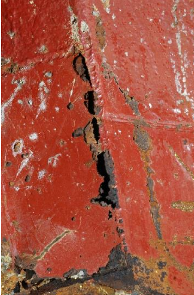
Εικόνα 28: Ζημία στο κάτω τμήμα πτυχωτής φρακτής, διακρίνεται εκτεταμένη διάβρωση στα σημεία όπου το επίστρωμα είχε απολεσθεί [66]
