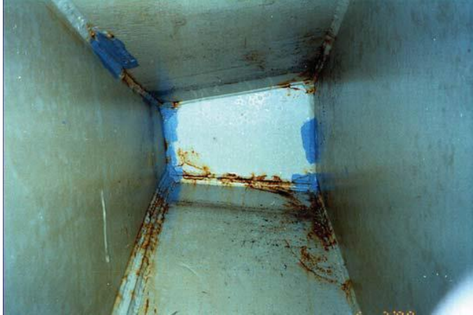
Εικόνα 36: Διάβρωση επί συγκολλήσεων [23]
