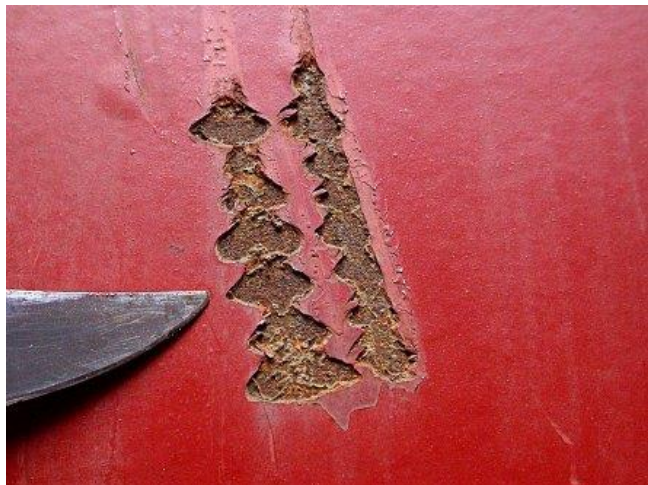
Εικόνα 24: Ρήξη επιστρώματος δενδροειδούς μορφής [61]
