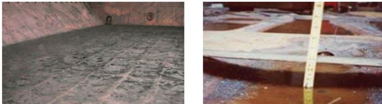
Εικόνα 17: Αριστερά: Εσωτερικός πυθμένας με μόνιμα βαθουλώματα από φορτίο και μηχανήματα εκφόρτωσης Δεξιά: Σχηματισμός κοιλότητων με συσσώρευση υδάτων που προκαλεί επιταχυνόμενη διάβρωση [56]
