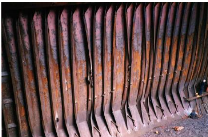
Εικόνα 19: Κατάρρευση νομέων πλευρικού ελάσματος [88]
