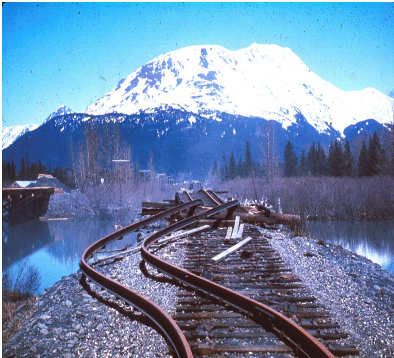
Εικόνα 2.16. Παραμόρφωση των γραμμών του σιδηροδρομικού δικτύου και του δρόμου στην περιοχή Portage κατά το σεισμό του 1964. Το περιβάλλον έδαφος έχει βυθιστεί εξαιτίας της επέλασης του νερού, όπως φαίνεται στα αριστερά της εικόνας.
