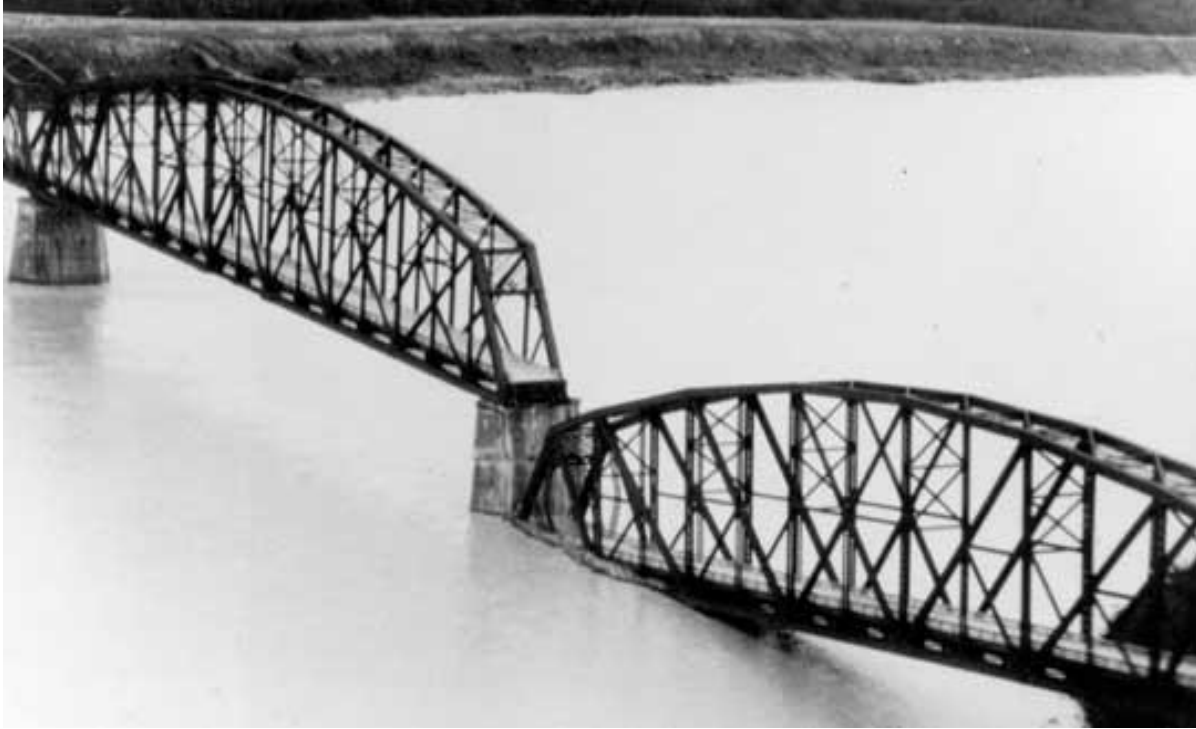
Εικόνα 2.15. Αλάσκα 1964, Αστοχία γέφυρας που προκλήθηκε από τη ρευστοποίηση των υποκείμενων εδαφικών σχηματισμών, αποτελούμενων ως επί τω πλείστον από ποτάμιες αποθέσεις, εξαιτίας του σεισμού
