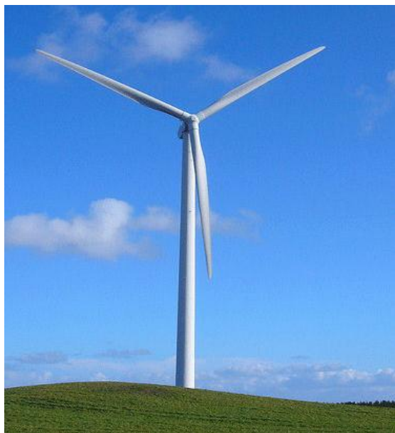
Εικόνα 10: Ανεμογεννήτρια οριζοντίου άξονα
