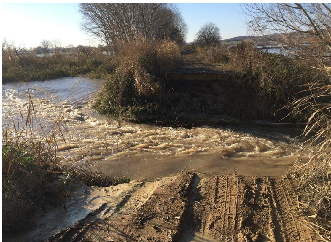
Σχήμα 5.5: Κατάρρευση αναχώματος στη Γεμιστή, 13/12/2014
