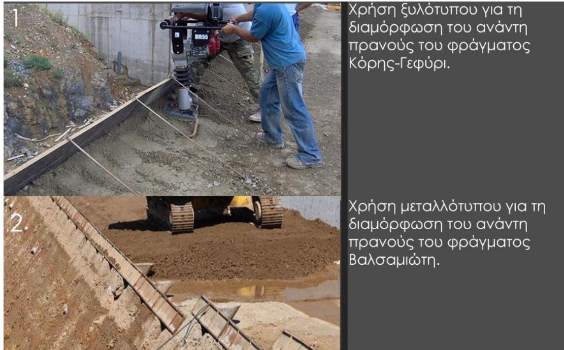
Εικόνα 11.2 Φωτογραφίες από διαμόρφωση πρσανών φραγμάτων ΑΚΣΕ με χρήση μεταλλοτύπων και ξυλοτύπων. (πηγή φωτογραφιών; (Ζαχαρόπουλος, 2014))
