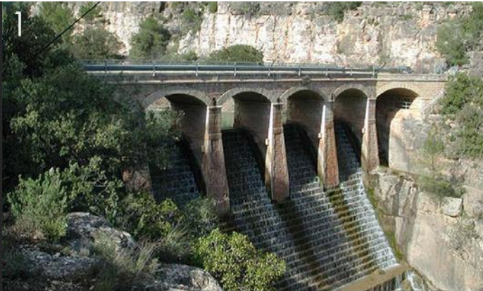
1 Όνομα: El Batanejo Χώρα: Ισπανία Τύπος: Λιθόχτιστο Φράγμα Ύψος: 21,5m Έτος ολοκλήρωσης: 1921
