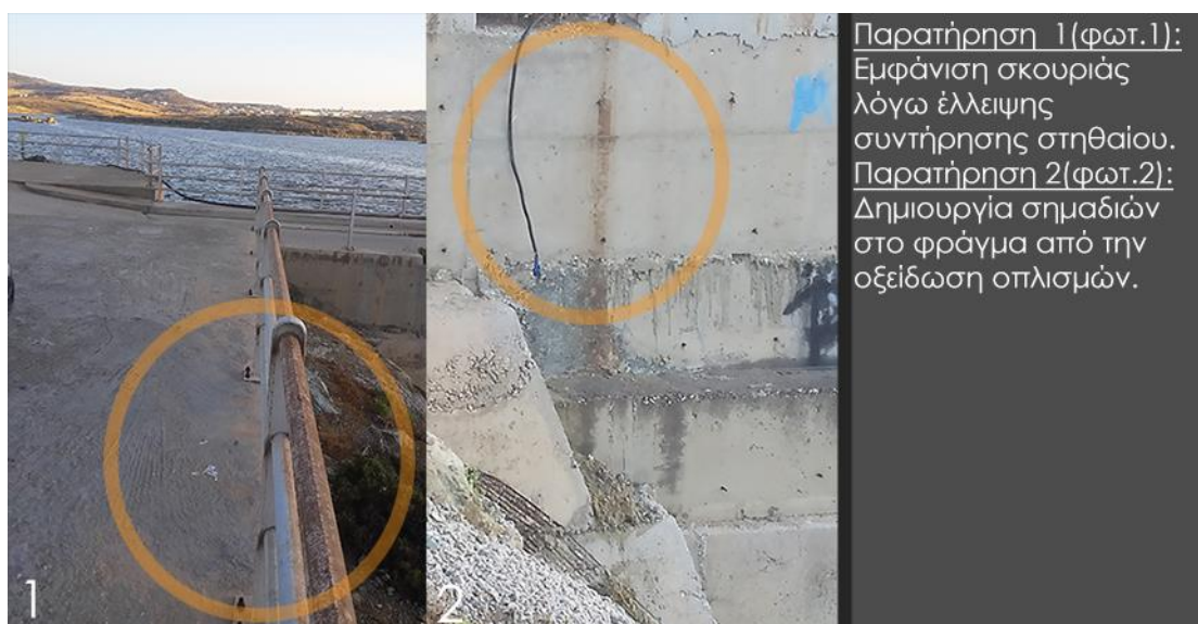
Εικόνα 6.4 Φωτογραφίες ενδείξεων έλλειψης συντήρησης του φράγματος Μαραθίου Μυκόνου (πηγή φωτογραφιών: φωτογραφίες του συντάκτη της εργασίας).
