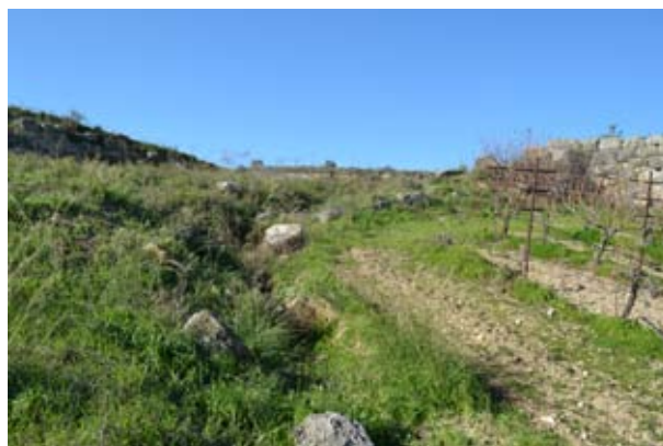
Κατάλοιπα τοίχου αντιστήριξης ανατολικά του αναλήμματος. Το νεροφάγωμα φανερώνει την αιτία της πλήρους διάλυσης αυτού του τοίχου.
