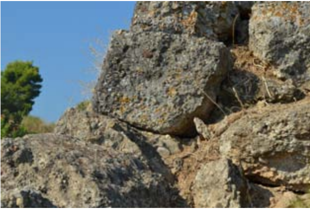
Λίθος in situ επί της ΒΑ παρειάς αναλήμματος. Είναι προφανής η κατωφέρεια των αρμών προς το εσωτερικό, κάτι τυπικό σε τοίχους αντιστήριξης εκείνης της εποχής.
