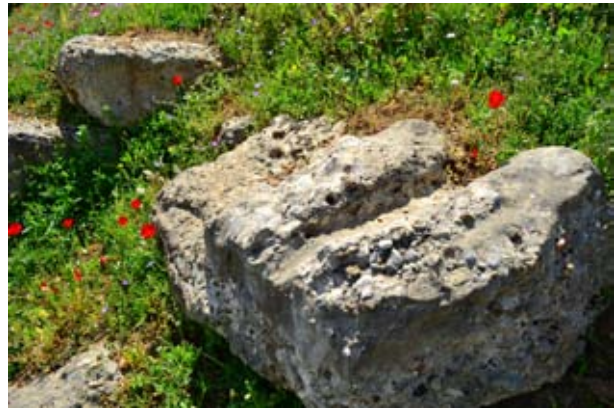
Αύλακα αποστράγγισης υδάτων στον τοίχο αντιστήριξης του νοτιοανατολικού πρανούς.
