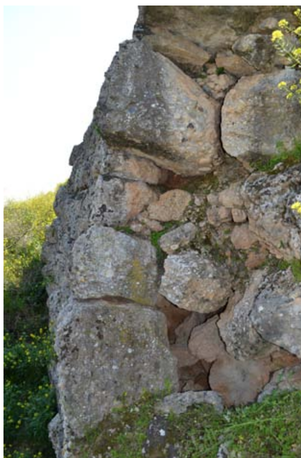
Η αντίστοιχη παρειά του τοίχου από τα δυτικά. Είναι προφανής η διαφορά του βαθμού διάβρωσης των λίθων σε σχέση με αυτών πίσω. Άποψη από τα δυτικά.
