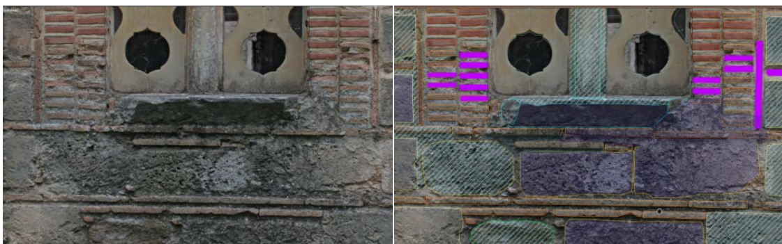
εικ.: κόγχη ιερού: μαύρη βιοδιάβρωση και απώλεια υλικού σε οπτοπλίνθους λόγω αποφλοιώσης εξωτερικών στοιβάδων, ορθοφωτογραφία και χαρτογράφηση
