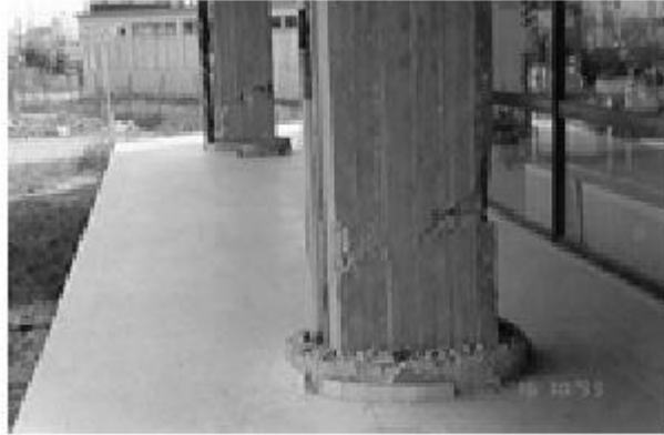
Σχήμα 1-1 Ρηγμάτωση υποστυλώματος λόγω κάμψης
