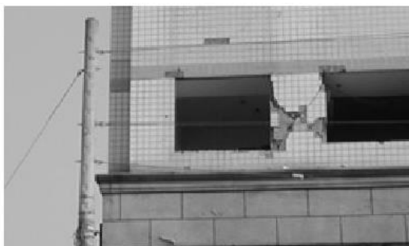
Σχήμα 1-5 Αστοχία τοιχώματος λόγω διάτμησης
