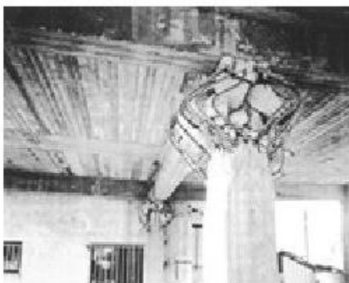
Σχήμα 1-4 Αστοχία με διακοπή της συνέχειας στοιχείου στην κρίσιμη περιοχή υποστυλώματος και κόμβου
