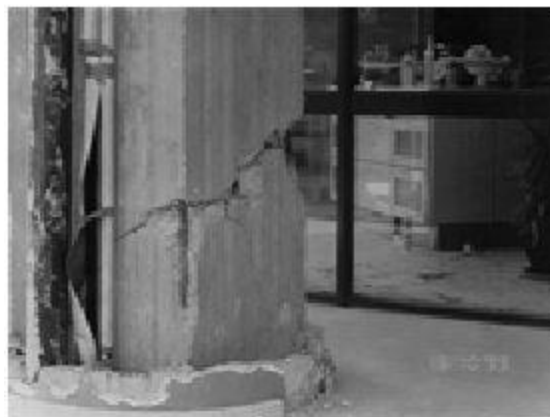
Σχήμα 1-2 Τοπική αποδιοργάνωση του σκυροδέματος υποστυλώματος
