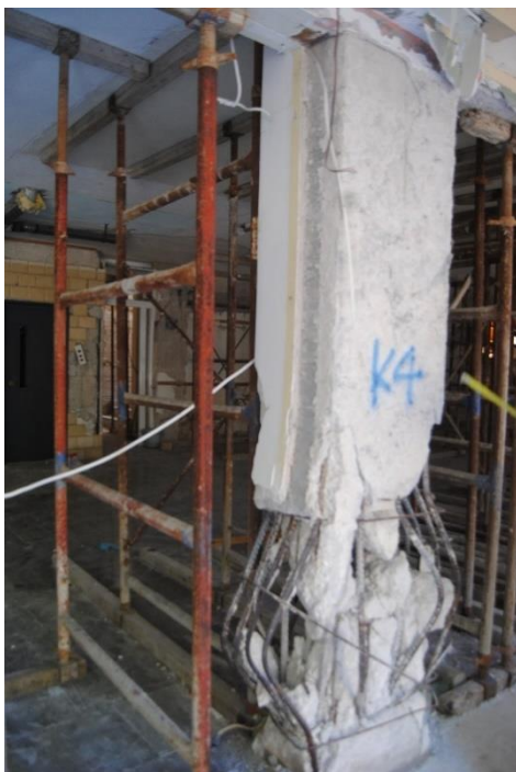
Εικόνα 4-14 Διακοπή συνέχειας υποστυλώματος λόγω πλήρους αποδιοργάνωσης του σκυροδέματος και βλάβης του διαμήκους οπλισμού και εγκάρσιου οπλισμού
