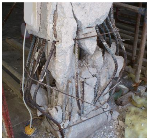
Εικόνα 4-17 Θραύση σκυροδέματος στοιχείου και λυγισμός διαμήκων οπλισμών
