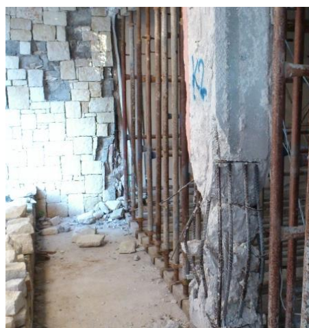
Εικόνα 4-19 Αστοχία κατασκευής λόγω λειτουργίας κατασκευής τύπου pilotis
