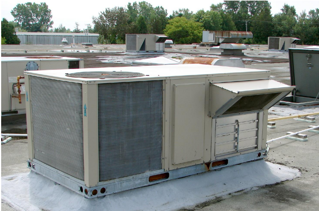
Εικόνα 1.32. Κλιματιστική μονάδα οροφής
