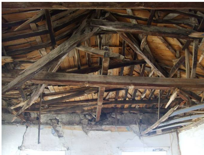
Αστοχία της στέγης
