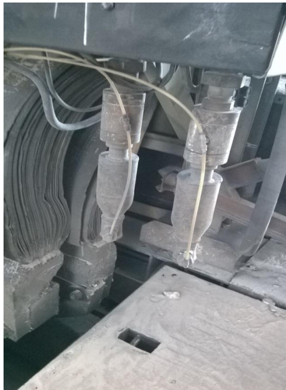
Εικόνα 17. Δοσιμέτρα λεκάνης ηλεκτρόλυσης
