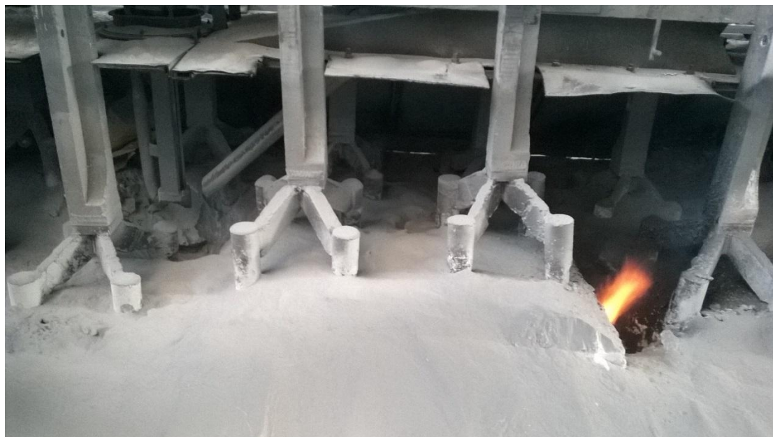
Εικόνα 15. Ανοικτή λεκάνη ηλεκτρόλυσης - Άνοδοι καλυμμένες με αλουμίνα
