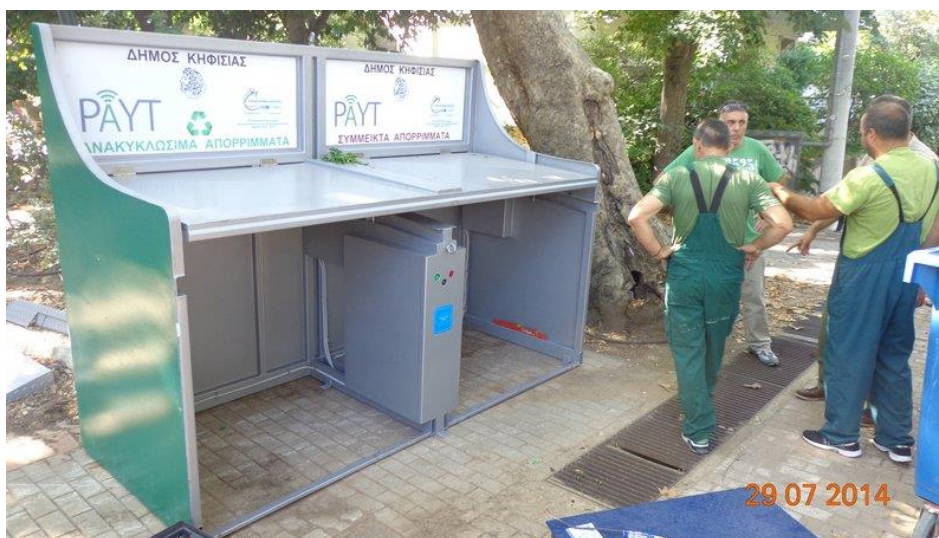
Εικόνα 6.1 : Εγκατάσταση πιλοτικού συστήματος στον Δήμο Κηφισιάς
