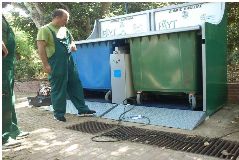
Εικόνα 6.2 : Εγκατάσταση πιλοτικού συστήματος στον Δήμο Κηφισιάς
