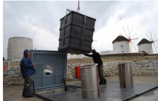
Εικόνα 3.6 : Άδειασμα υπόγειων κάδων Sotcon
