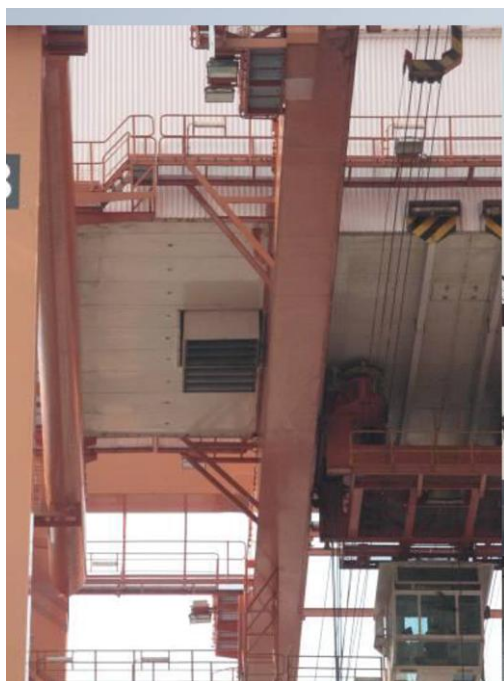
Εικόνα: Μονωμένη έξοδος εξαερισμού σε γερανογέφυρα
