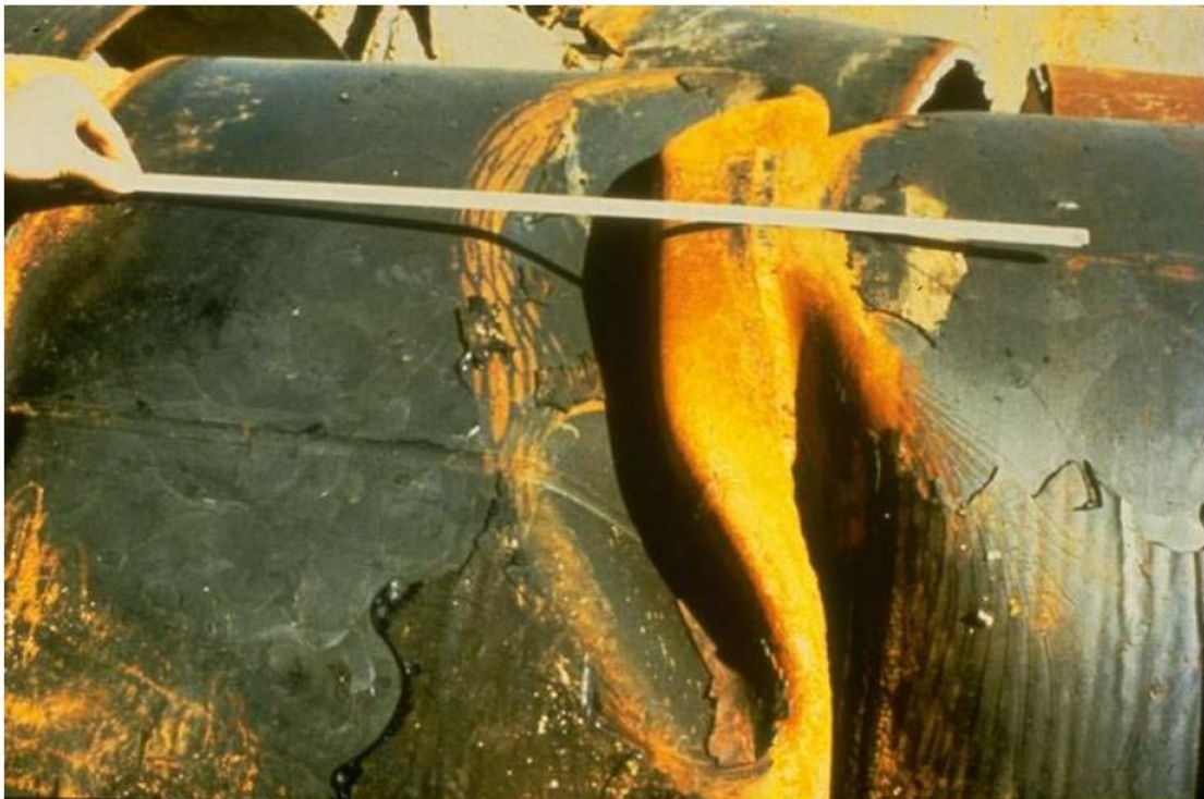
Σχήμα 1.5.10. Λυγισμός αγωγού λόγω συμπίεσης από ρήγμα (Takada et al.2001).
