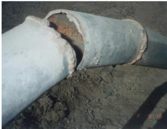
Σχήμα 1.5.7. Fault-βλάβες που προκαλούνται από βλάβη των αγωγών στον σεισμό Manjil 1990, Iran (Sim et al.2012).
