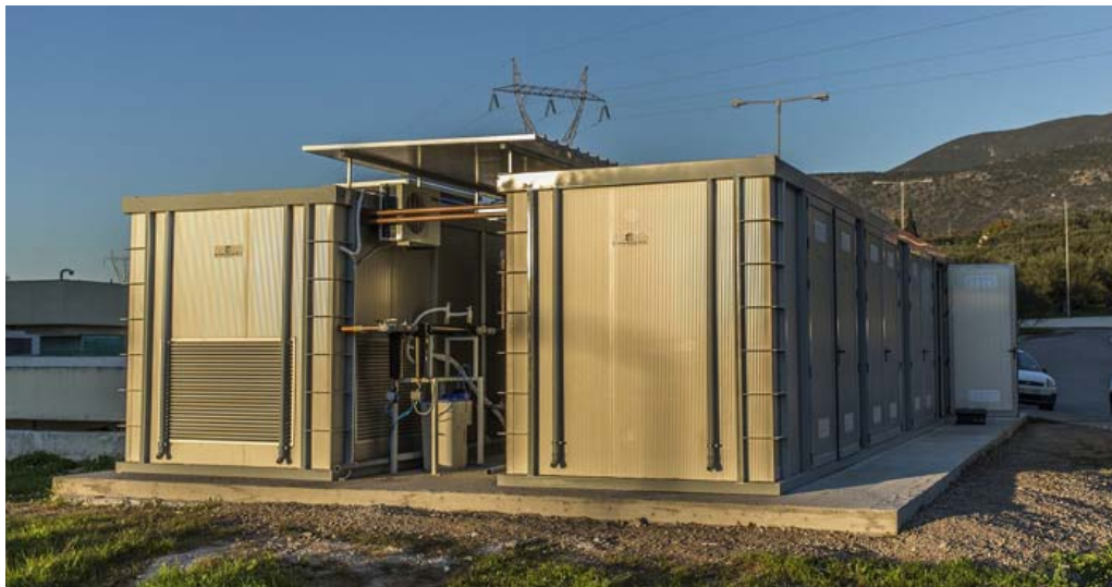
Εικόνα 4.3: Συγκρότημα γεννητριών παραγωγής ιατρικού οξυγόνου. Γενικό Νοσοκομείο Καλαμάτας [44] .
