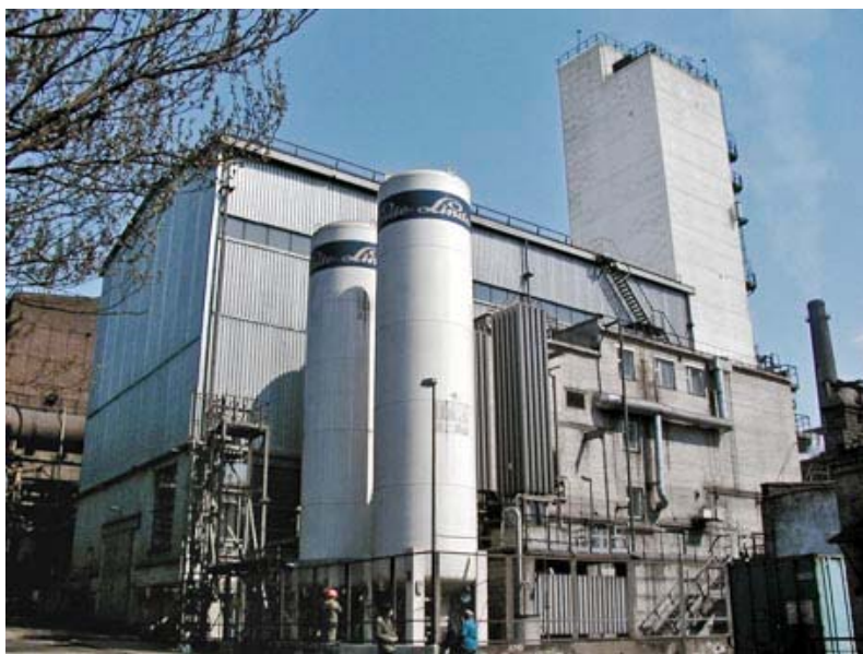
Εικόνα 1.5: Μονάδα Κρυογονικού διαχωρισμού του αέρα [25] .
