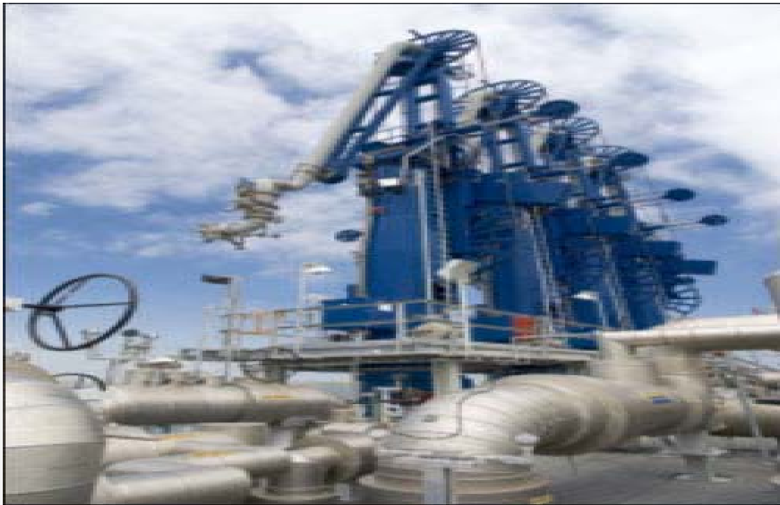
Εικόνα 1. Βραχίονες τροφοδοσίας πλοίου με LNG (Loading Arm)
