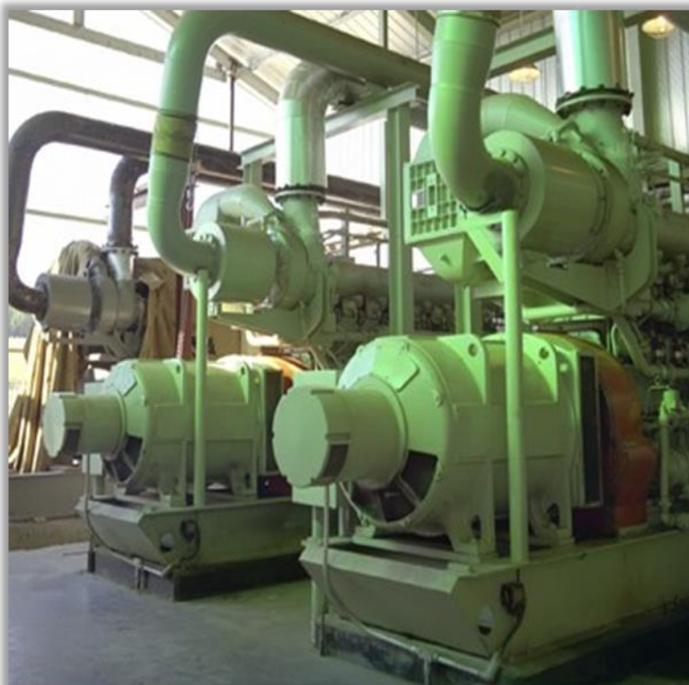
Σχήμα 2-08: Σταθμοί συμπίεσης Φυσικού αερίου (Πηγή: www.endlessmtnlifestyles.com/?p=1134 ) [10]
