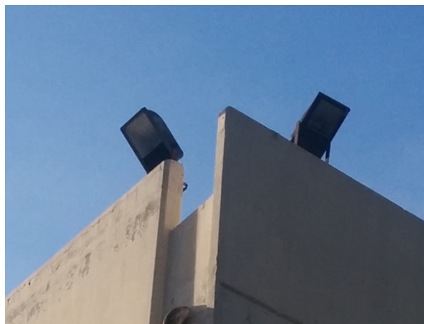
Σχήμα 3 – Προβολείς σε κτίριο του Ε.Μ.Π.
