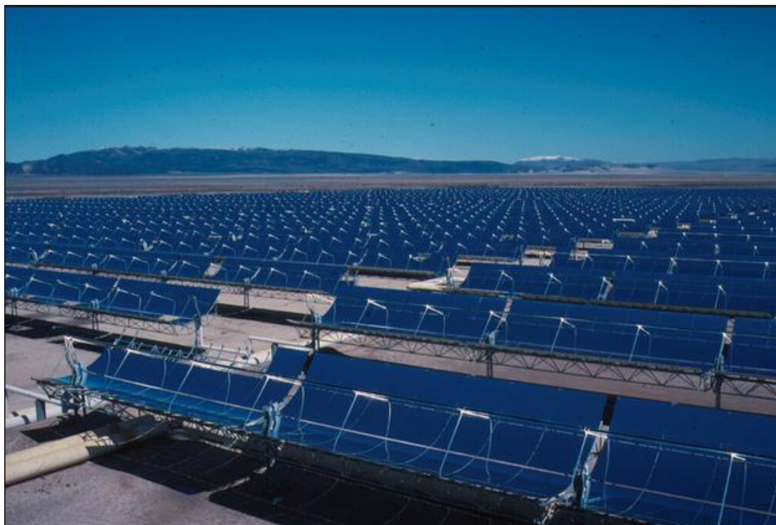
Εικόνα 6.2: Μέρος της εγκατάστασης
