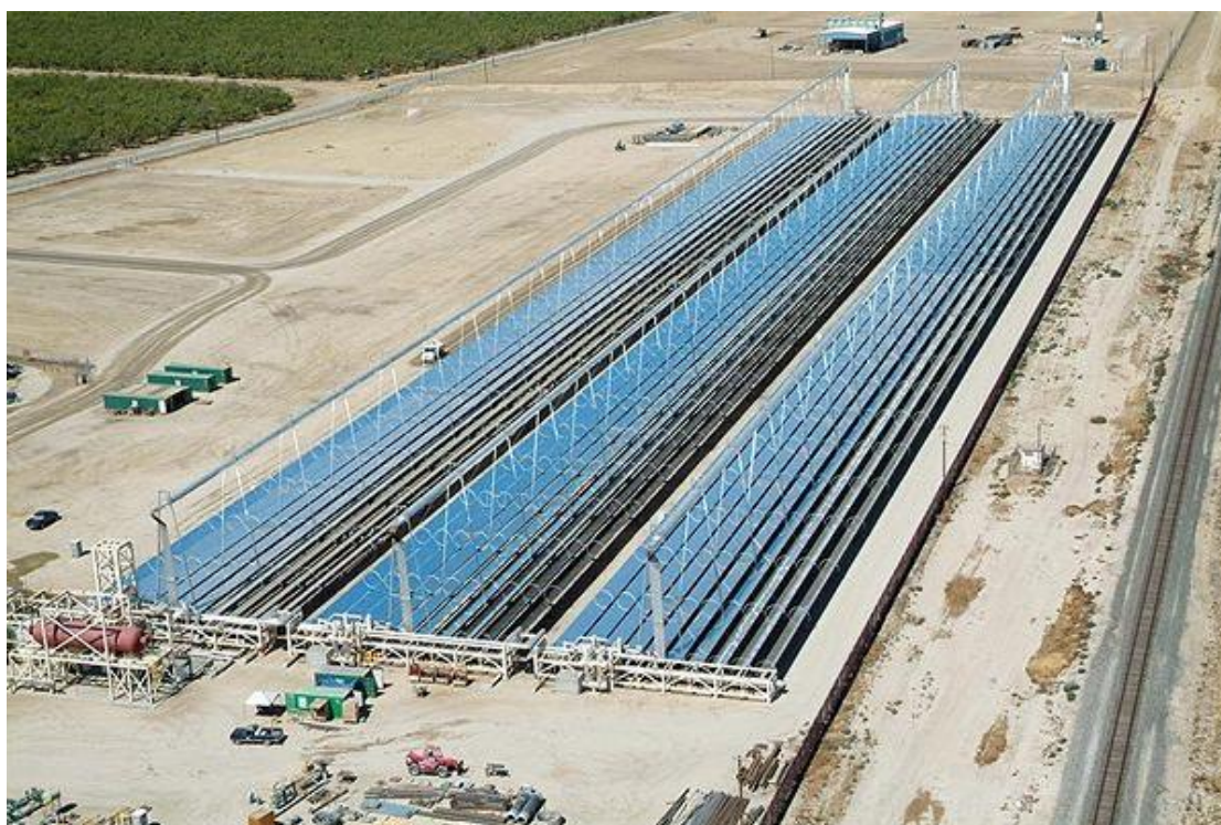
Εικόνα 6.5: Ηλιοθερμικό εργοστάσιο Kimberlina Solar
