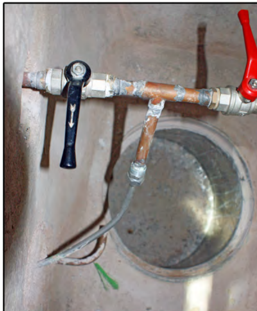
11. Δοχείο - δεξαμενή ζεστού νερού
