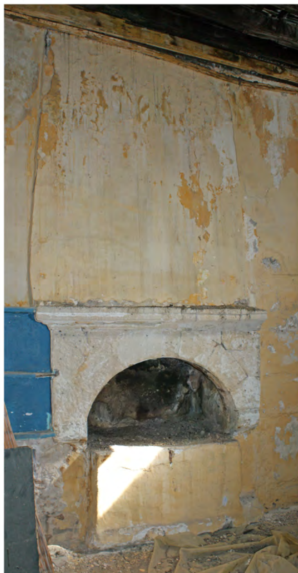
10. Εστία μαγειρείου στον όροφο
