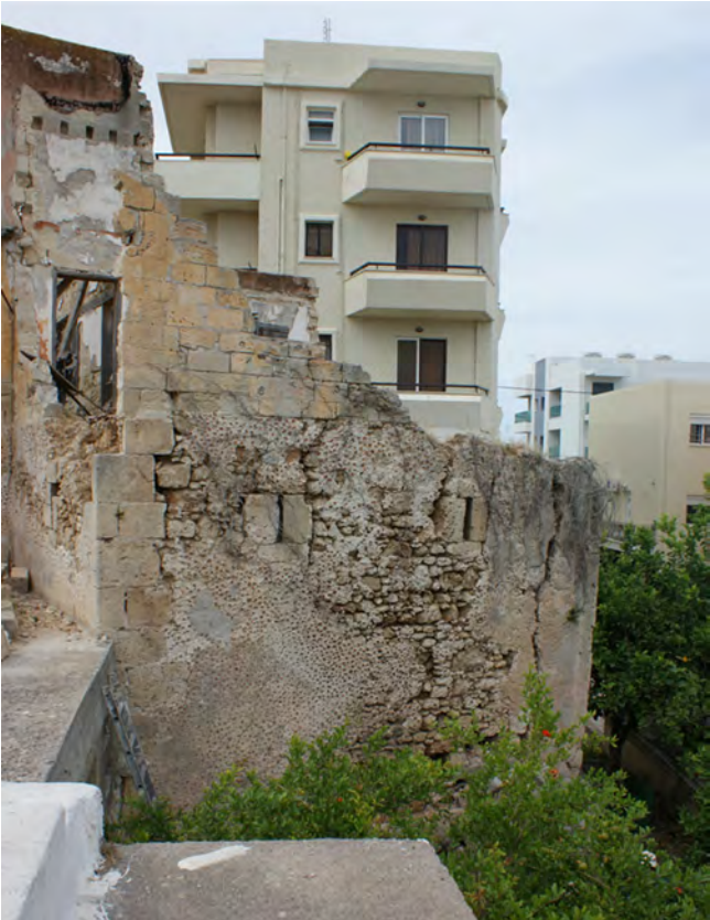
139. Μετατροπή κτίσματος σε σκουπιδότοπο
