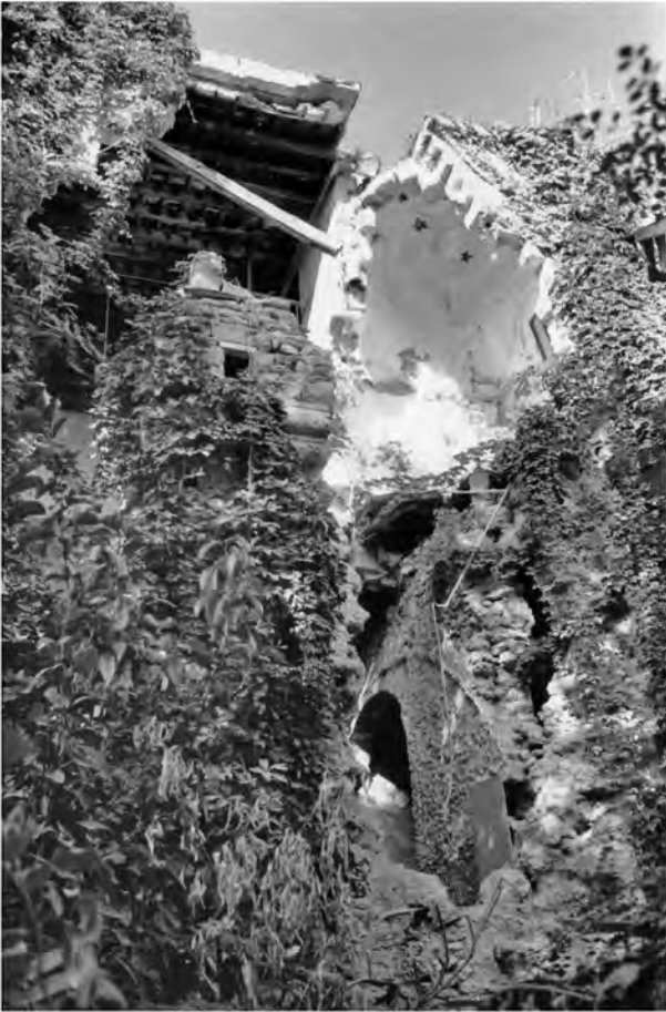
Αποψη λουτρού πριν την ολική κατάρρευση
