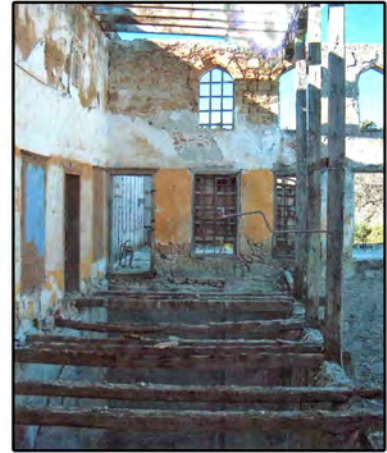
8. Χαγιάτι εξωτερικό πριν την αποκατάσταση
