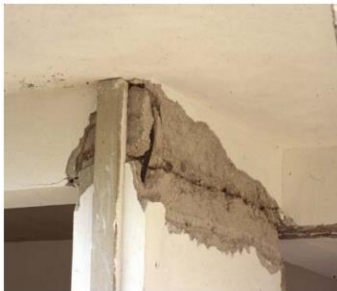
Εικ. 20 Ανεπαρκής αγκύρωση κάτω ράβδων δοκού λόγω σκυροδέτησης υποστυλώματος πάνω από τη μασχάλη δοκού [ 3 ]
