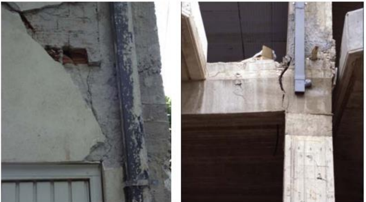
Εικ. 19 Ανεπαρκής αγκύρωση πάνω & κάτω ράβδων δοκού [ 3 ]
